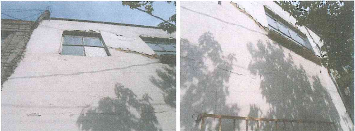
Foto 11 y 12. Fisuras en aplanados de la fachada. Esta misma fachada presenta un desplome hacia adentro de 3 centímetros tomado a nivel de banqueta. Se recomienda tomar el desplome de la fachada completa.
