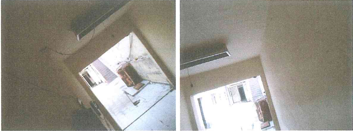
Foto 13 y 14. Garaje y patio interior con fisuras y deterioro en los aplanados de muros y en los acabados en piso.
