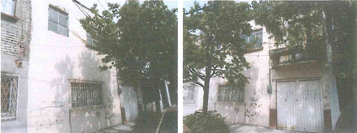
Foto 5 y 6. Fachada principal que presenta un desplome hacia su interior.
