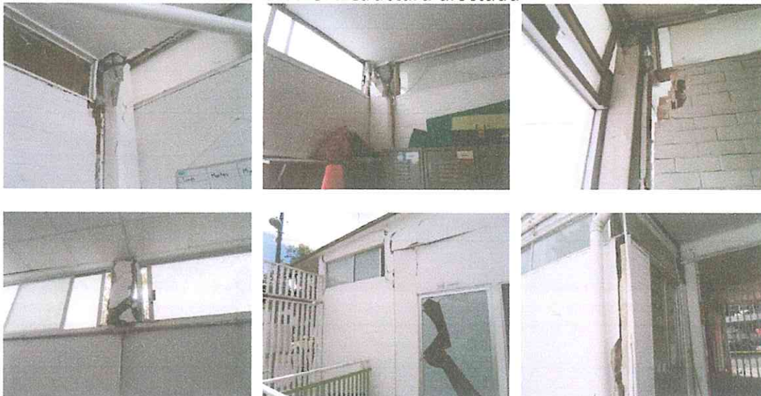
ANTES: Estructura afectada
