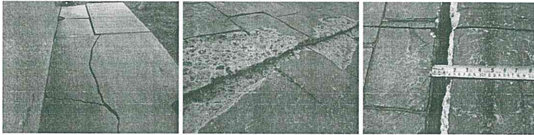
ANTES: Firmes afectados.
