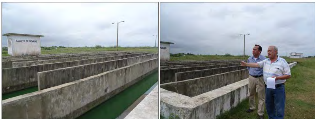
Figura 14 Planta de Tratamiento Ciudad Olmeca
