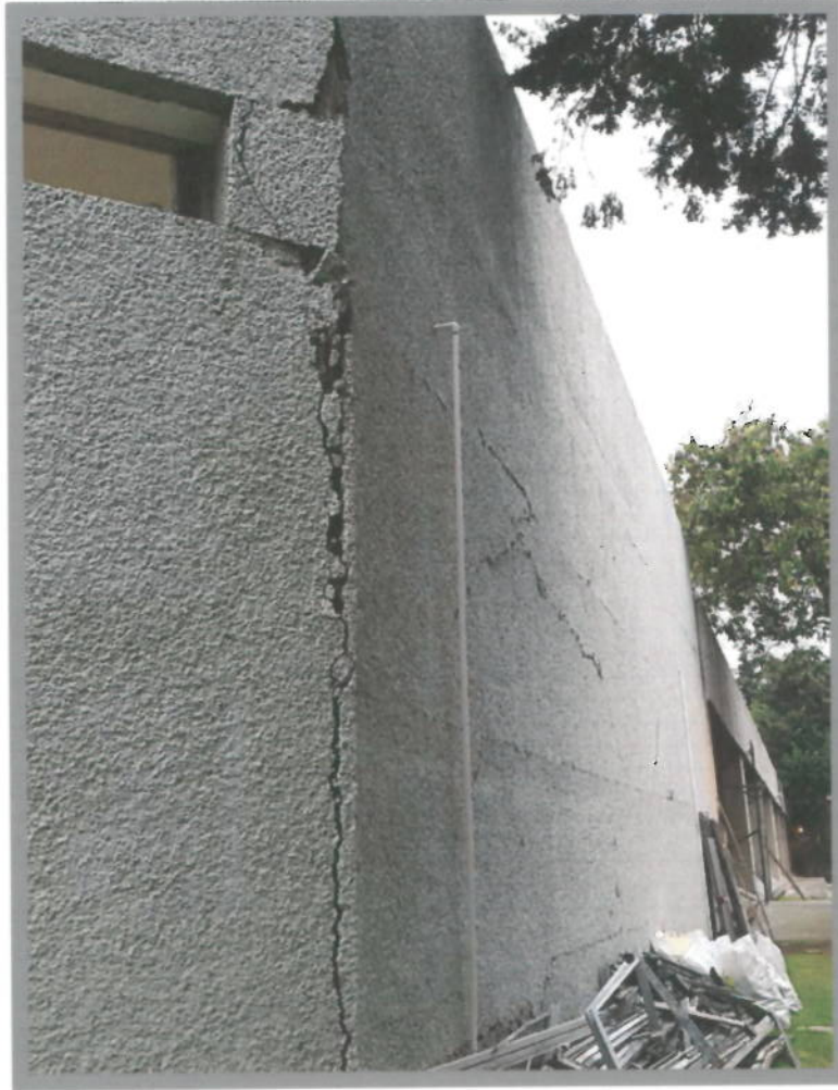
Foto 15 Desprendimiento de acabado de muros de fachadas (No es daño estructural); sin embargo, se recomienda delimitar su zona adyacente como insegura mientras se retira el aplanado suelto
