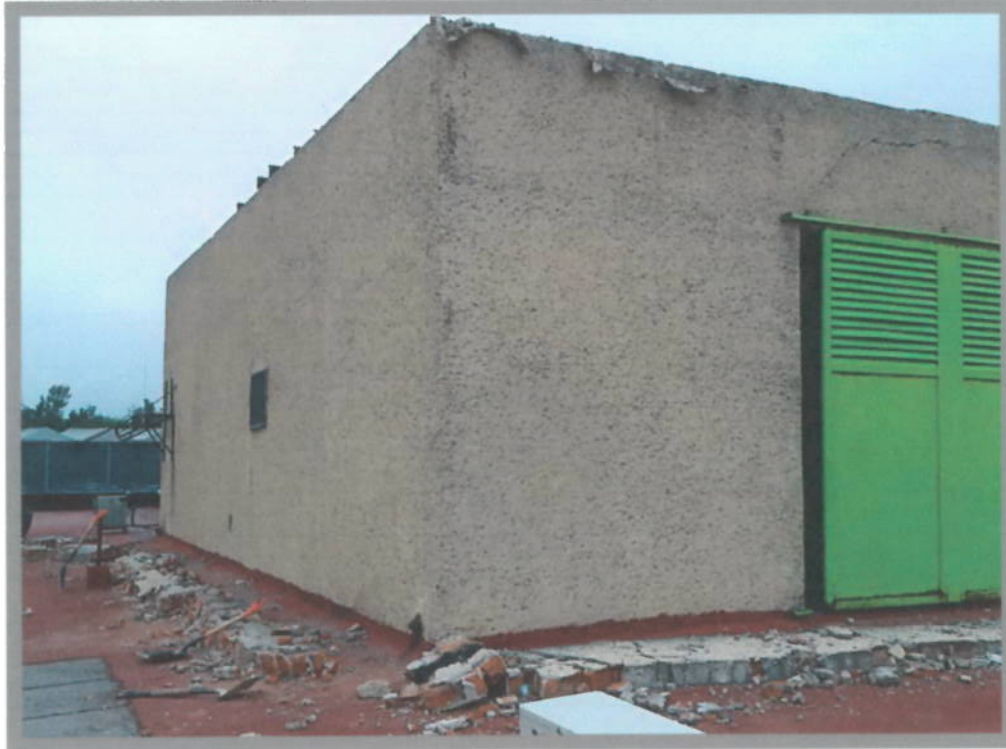
Foto 7 Caída de pretil de cuartos de ULA en azotea
