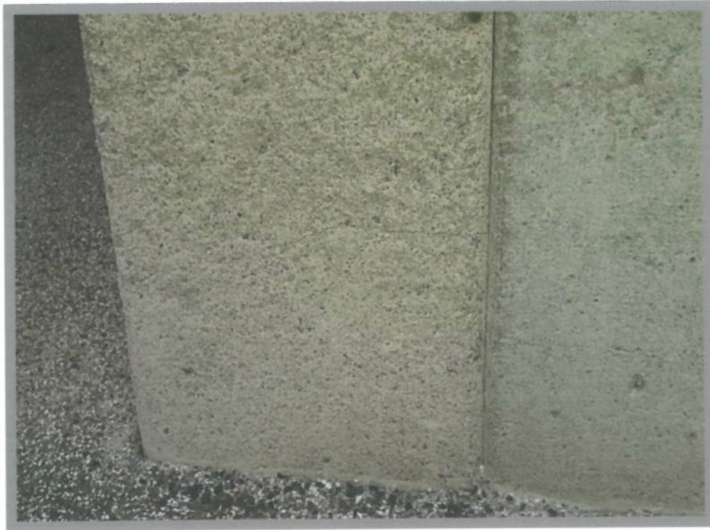
Foto 14 Fisura en la columna falsa de la izquierda (No es daño estructural)
