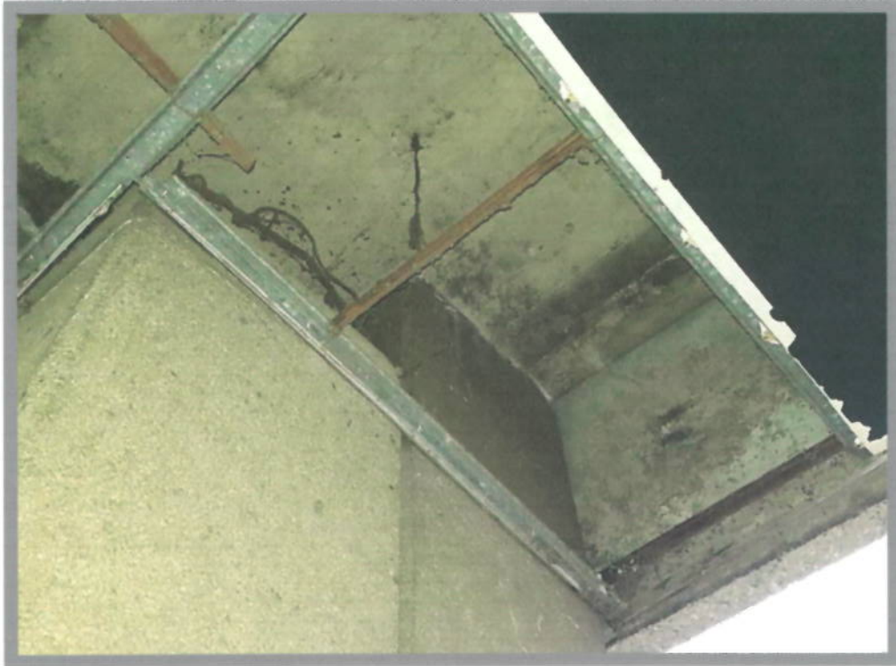
Foto 12 Se aprecia que existen columnas falsas que se agrietaron como la de la izquierda
