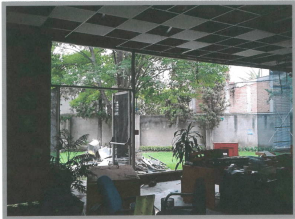
Foto 16 Ruptura de algunos vidrios por la flexibilidad del sistema estructural
