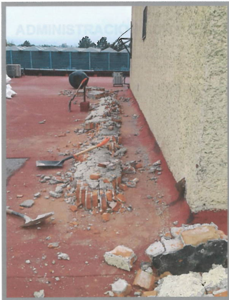
Foto 8 Caída de pretil de cuartos de ULA en azotea. Se encuentra en proceso de retiro de escombros
