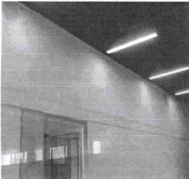
Imagen 8. Apartamiento de aplanado y muro en confinamiento con trabe. Área Administrativa.
