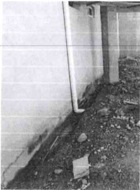
Imagen 15. Humedad en aplanados exteriores de muros en la Planta Baja de la Cafetería.
