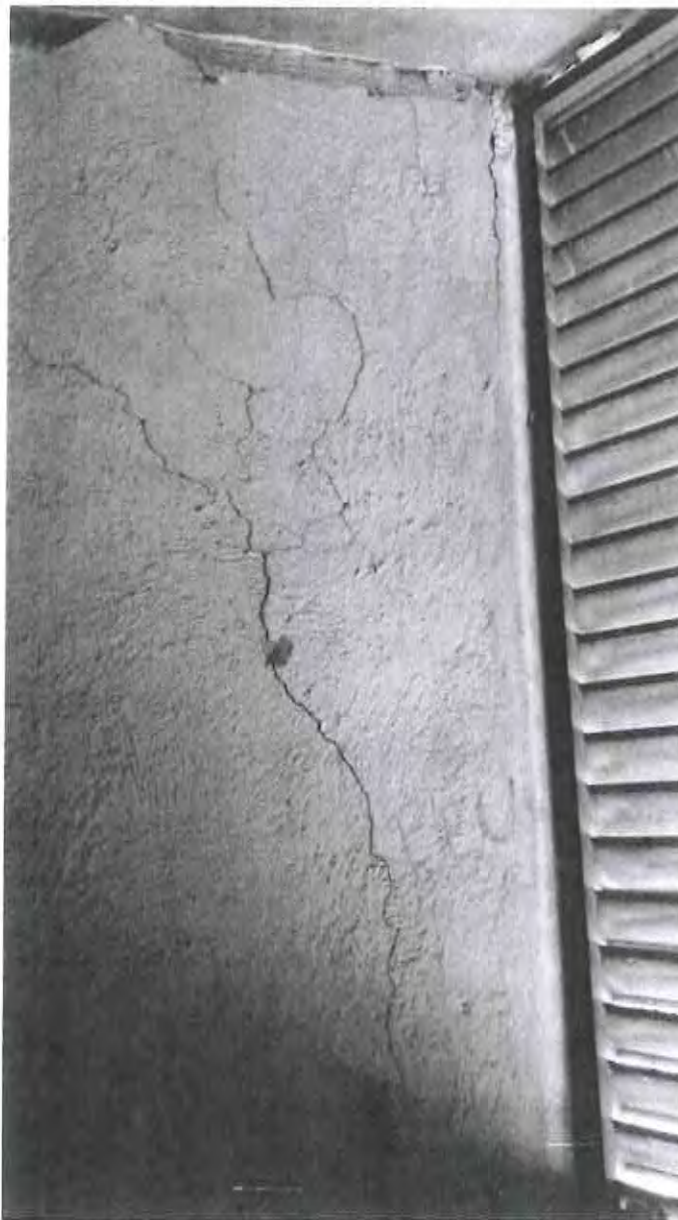
FISURA DE APLANADOS DE MORTERO DE MUROS DIVISORIOS
