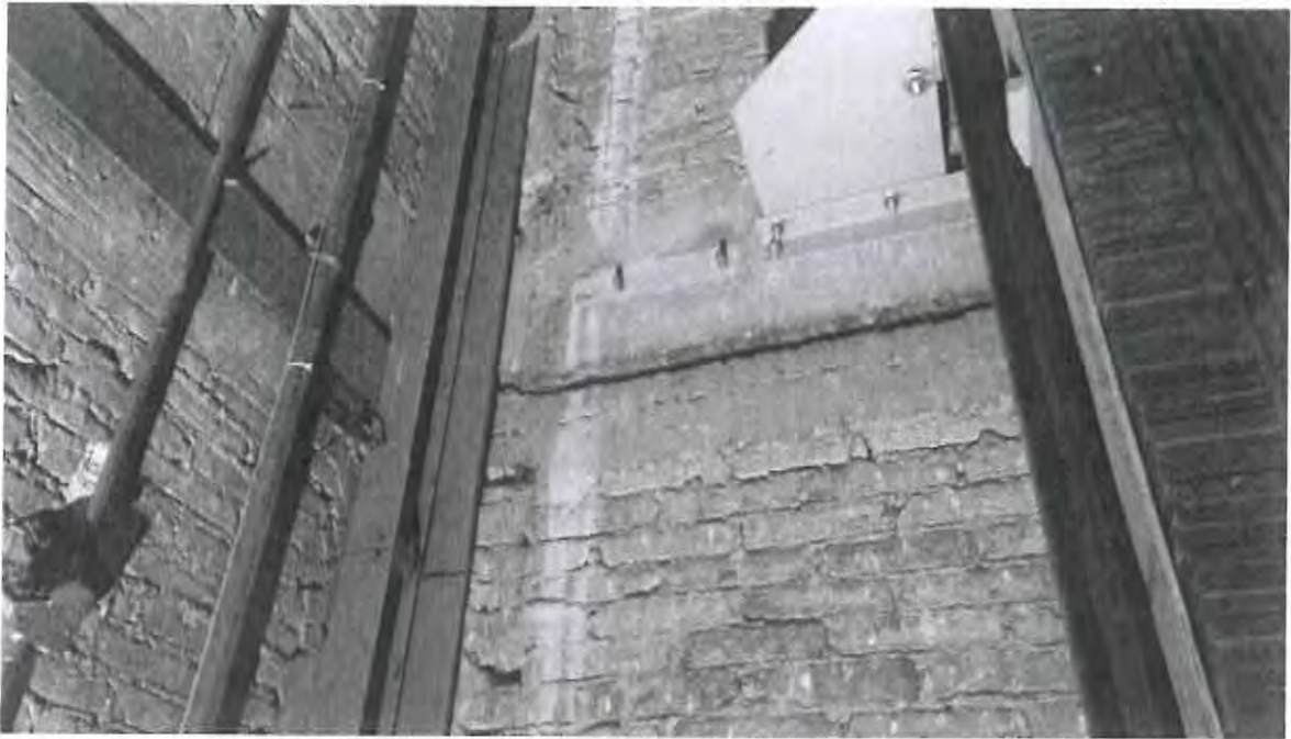
MUROS DE DUCTOS DE ELEVADORES DE TABIQUE ROJO, DESLIGADOS DE LA ESTRUCTURA.
