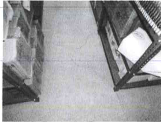
Imagen 6. Cuarteadura en piso de almacén de libros
