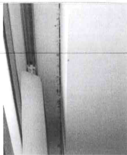
Imagen 16. Oxido en viga de acero
