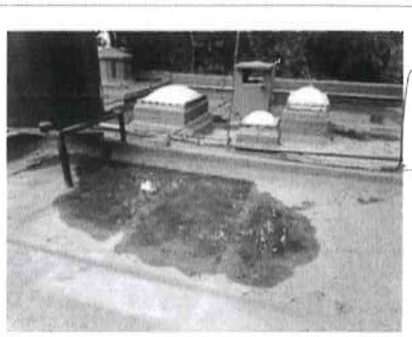
Imagen 8. Concentración de agua en azotea
