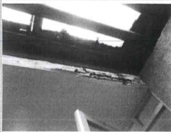
Imagen 13. Humedad en Pretil de azotea
