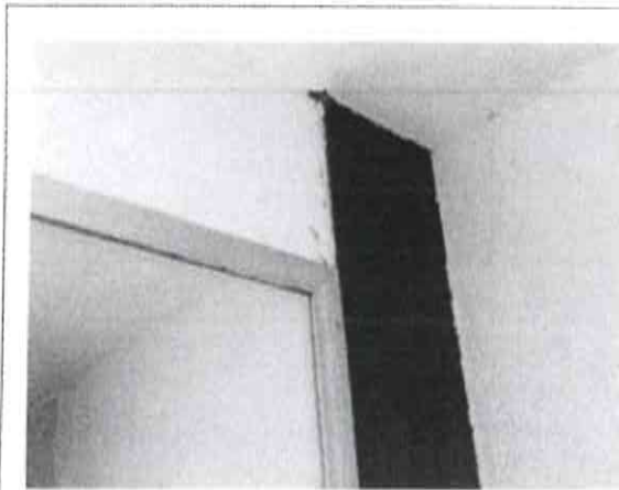
Imagen 11. Fisura en unión de aristas
