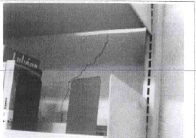
Imagen 10. Fisuras en aplanados de muros ponientes
