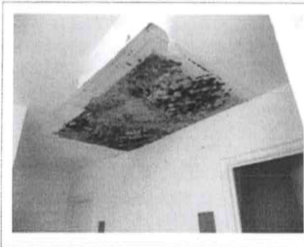
Imagen 13. Fuertes problemas de humedad en plafón
