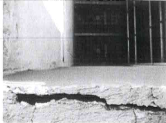
Imagen 14. Desprendimiento de aplanados
