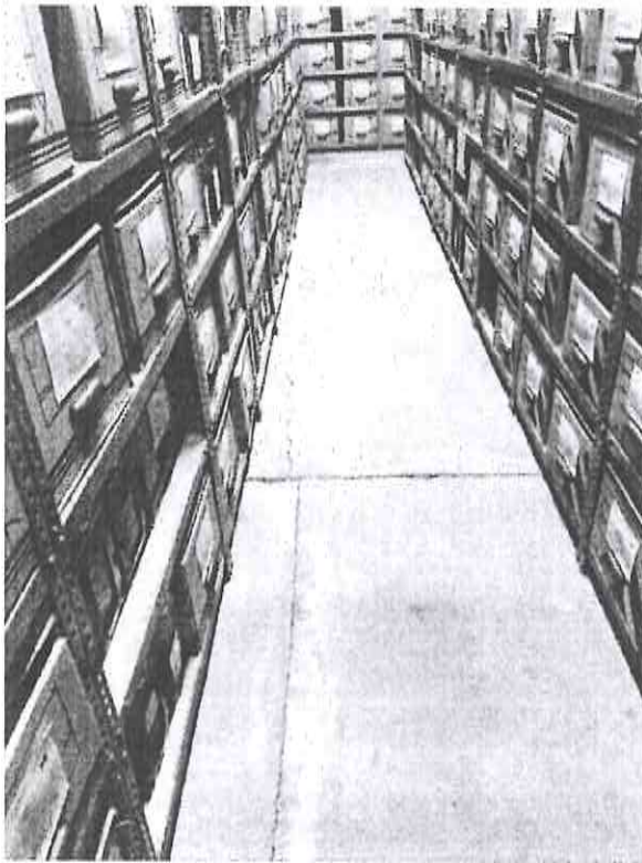
AGRIETAMIENTOS EN PISOS
