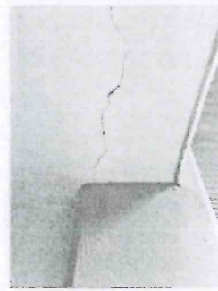
Foto 6.- Fisuras en junta fría de plafón.
