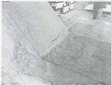
Foto 27.-Muro divisorio con grietas horizontales en su recubrimiento.
