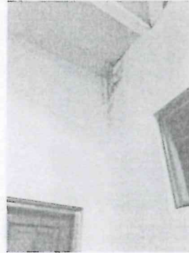
Foto 28.-Filtraciones en el área de cubículos.
