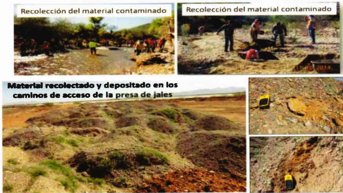
Figura 1.3 Recolecta de material visiblemente impactado por el derrame y posteriormente depositado en los caminos de acceso de la presa de jales de Buena Vista del Cobre
