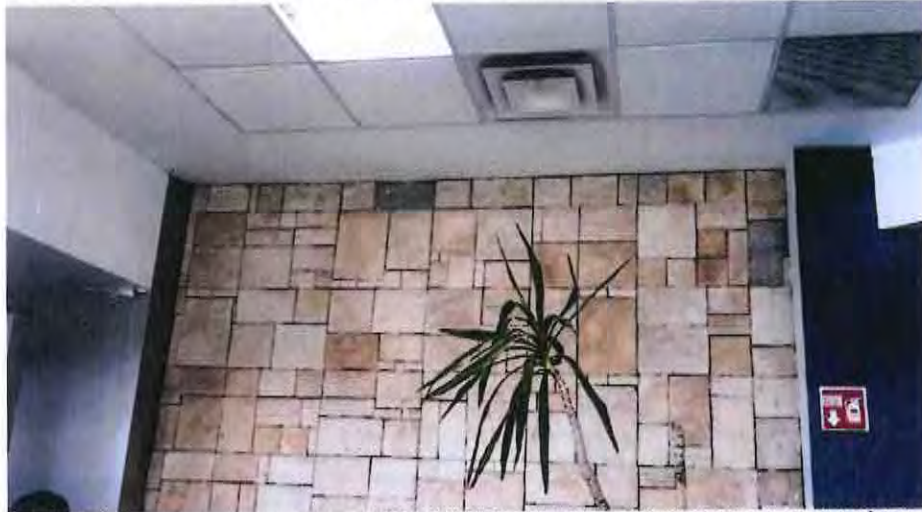
FOTOGRAFÍA 1. PLANTA BAJA. DESCARAPELAMIENTO DEL ACABADO EN PINTURA EN PLAFÓN Y MURO Y FISURA EN ACABADOS DE MURO EN ZONA DE ACCESO.
