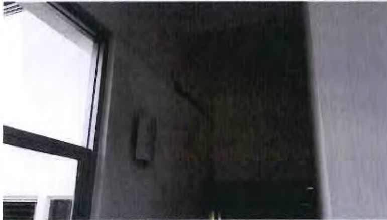
FOTOGRAFÍA 37 MURO DE FACHADA EN ZONA DE ESCALERA FISURA VERTICAL Y DESCARAPELAMIENTO DE ACABADO EN TRABE, FISURAS MUY 22 RECURRENTES Y ENCONTRADAS EN NIVEL 3 Y 4. EN EL EXTREMO DERECHO SE OBSERVA EL MURO DE ELEVADOR EN BUEN ESTADO.
