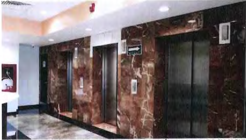
FOTOGRAFÍA 13. ELEVADORES EN FUNCIONAMIENTO, CON CAÍDA DE ACABADO EN ALGUNAS ZONAS.
