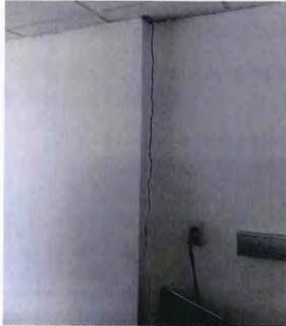
FOTOGRAFÍA 20. FISURA VERTICAL EN UNIÓN ENTRE MURO CON COLUMNA SIN AFECTAR LA ESTABILIDAD DE LA ESTRUCTURA.
