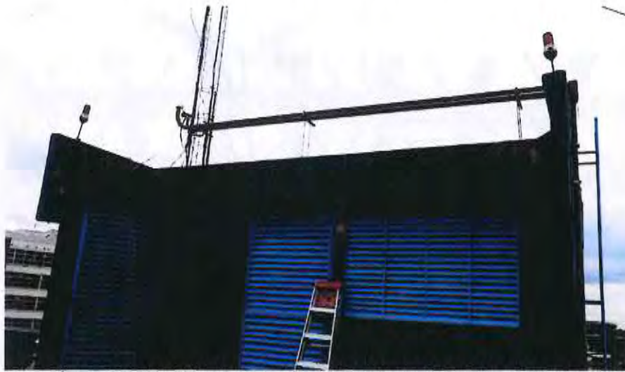
FOTOGRAFÍA 45. SOBREPASO EN AZOTEA, LA LOSA Y EL PRETIL PRESENTAN DESCARAPELAMIENTO DE ACABADO Y FALTA DE MANTENIMIENTO.
