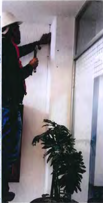
FOTOGRAFIA 13. NIVEL 1, PROCEDIMIENTO PARA COMPROBAR QUE LA COLUMNA NO ESTE DAÑADA, EN LA FISURA VERTICAL DE LA UNION CON EL MURO DIVISORIO.
