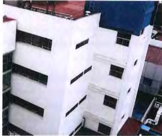
FOTOGRAFÍA 47. FACHADA POSTERIOR. A EXCEPCIÓN DE ALGUNAS FISURAS EN UNIONES DE PRETILES CON ESTRUCTURA PRINCIPAL, LA FACHADA SE OBSERVA EN BUEN ESTADO Y NO PRESENTA RIESGO VISIBLE DE ACABADOS.
