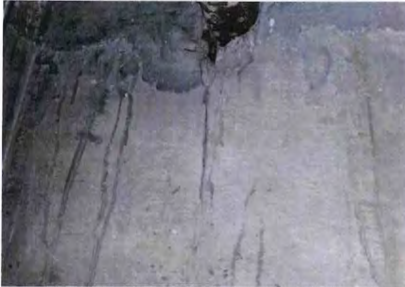
FOTOGRAFÍA 16. FISURA EN DIAGONAL EN TRABE DESDE LA VIGA DOBLE T.
