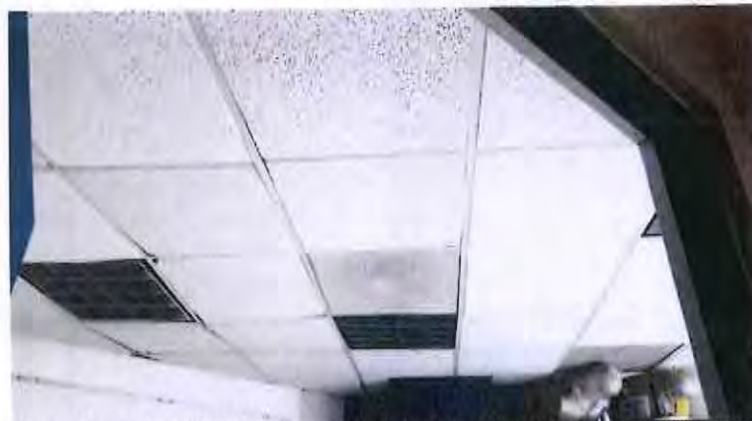
FOTOGRAFÍA 6. LA COLOCACIÓN DE PLAFONES ESTA EN MUY MAL ESTADO EN VARIAS ZONAS, SOBRE TODO EN LA CRUJIA TRIANGULAR, SIN EMBARGO, SE NOS ÍNDICO QUE ESTO ES ANTERIOR A LOS SISMOS.
