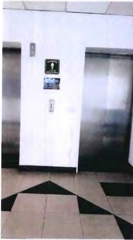
FOTOGRAFÍA 7. ELEVADORES EN FUNCIONAMIENTO, CON PEQUEÑAS FISURAS EN LA ESQUINA SUPERIOR DEL VANO DE ACCESO Y DESCARAPELAMIENTO DE PINTURA.
