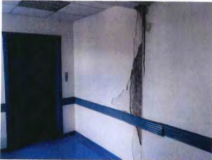
FOTOGRAFÍA 6. CAÍDA DE ACABADO EN JUNTA CONSTRUCTIVA DE ELEMENTO ESTRUCTURAL CON MURO DIVISORIO.
