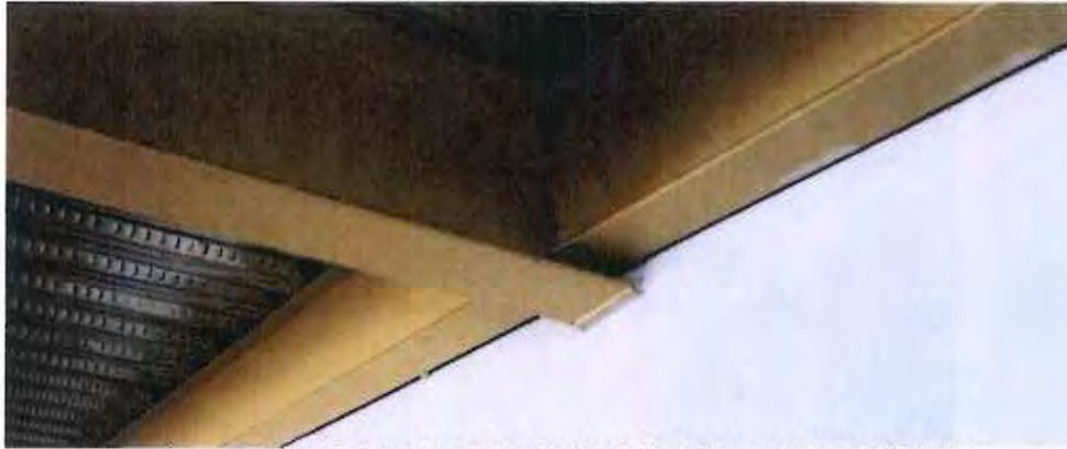
FOTOGRAFÍA 14. REEMPLAZAR PLACA DE CONEXIÓN DE TRABE EN RAMPA DE SÓTANO 2.
