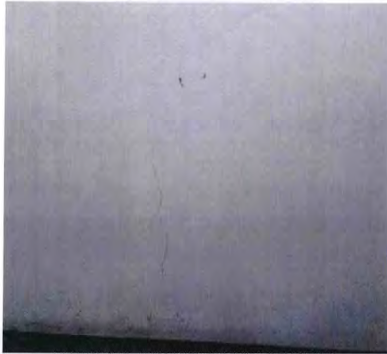
FOTOGRAFÍA 24. FISURA EN MURO DIVISORIO DE SÓTANO.
