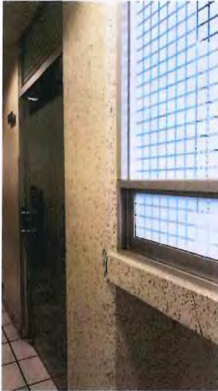
FOTOGRAFÍA 41. NIVEL 4 EJE I-1, DESCARPELAMIENTO DE ACABADO EN UNIÓN DE TRABE LOSA DE PRETEL Y COLUMNA DE ESTRUCTURA PRINCIPAL, QUE SE ENCUENTRA EN BUEN ESTADO, TAMBIÉN HAY UNA FISURA EN DIAGONAL EN LA LOSA DE PRETEL.
