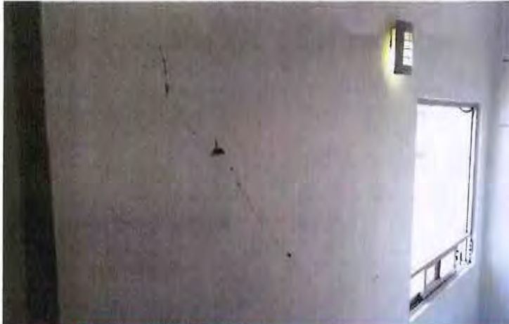
FOTOGRAFÍA 29. EN ZONA DE ESCALERA DE NIVEL 2 A NIVEL 3 DESCARAPELAMIENT TO DE ACABADO EN MURO DE FACHADA.
