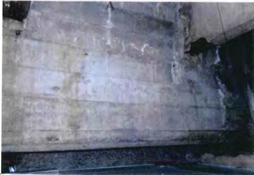
FOTOGRAFÍA 29. FISURA EN DIAGONAL EN TRABE DE CONCRETO.
