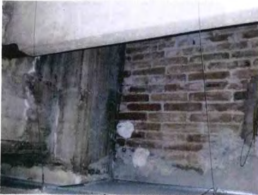
FOTOGRAFÍA 28. NODO DE COLUMNA Y TRABE DE CONCRETO PRINCIPAL Y VIGA DOBLE T. MURO DE TABIQUE SIN CASTILLO EN EXTREMOS DE MURO PARA DESLIGAR DE LA ESTRUCTURA PRINCIPAL, MURO DE TABIQUE SIN CASTILLO EN EXTREMO DE MURO PARA DESLIGAR DE LA ESTRUCTURA PRINCIPAL.
