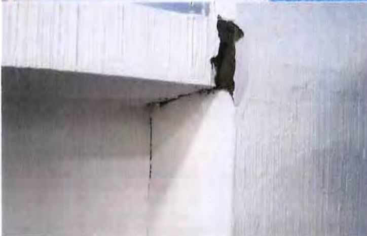
FOTOGRAFÍA 31 NIVEL 3 DESCARAPELAMIENT TO DE ACABADO EN TRABE LOSA DE PRETIL EN UNIÓN CON COLUMNA DE CONCRETO, LA CUAL NO SE DAÑÓ.
