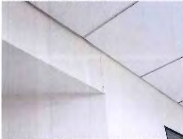
FOTOGRAFÍA 35. FISURAS EN UNIONES DE MUROS Y PLAFONES.
