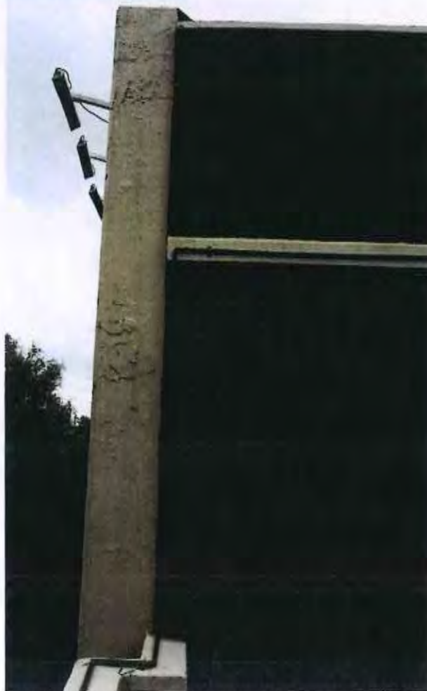
FOTOGRAFÍA 24. NIVEL DE AZOTEA. FISURA EN PRETEL Y REPISÓN DE CONCRETO.
