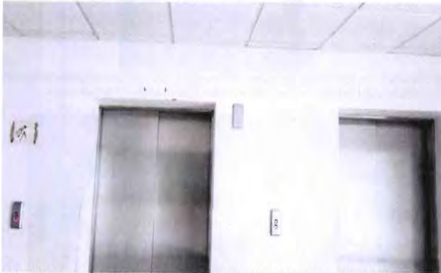
FOTOGRAFÍA 4. ELEVADORES EN FUNCIONAMIENTO, SOLO DESCARAPELAMIENTO DE PINTURA.
