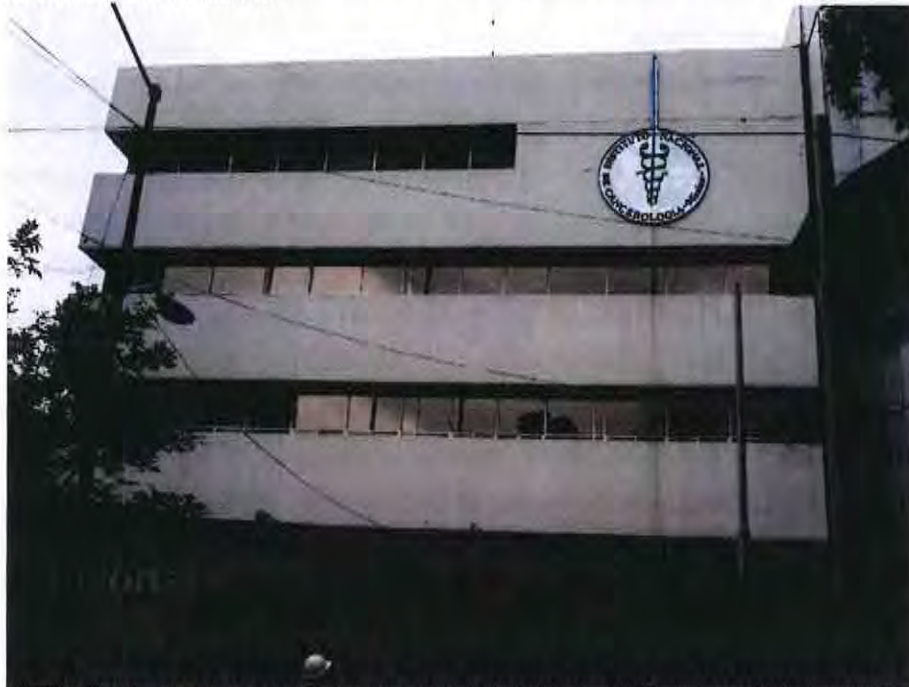
FOTOGRAFIA 48. FACHADA PRINCIPAL. SIN RIESGO VISIBLE DE CAIDA DE ELEMENTOS, SOLO CON ALGUNAS FISURAS EN UNIONES DE PRETILES CON ESTRUCTURA PRINCIPAL, SIN VIDRIOS ROTOS E INSTALACIONES EN MAL ESTADO.
