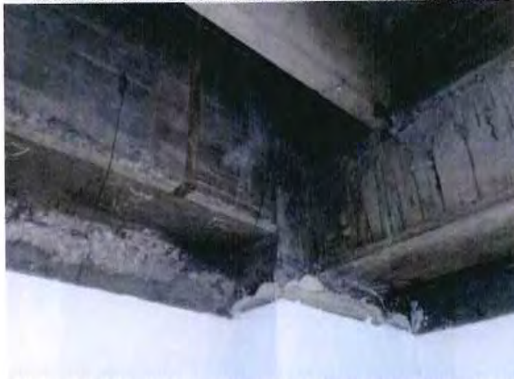
FOTOGRAFÍA 35. NODO DE COLUMNA Y TRABES PRINCIPALES DE CONCRETO. MURO DIVISORIO DE TABIQUE NO DESLIGADO DE TRABE PRINCIPAL.
