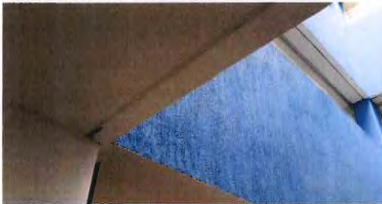
FOTOGRAFÍA 10. NIVEL 1 EJE 6I. FISURA EN UNION DE TRABE PERIMETRAL DE PRETIL, PLAFÓN Y COLUMNA, SIN AFECTAR LA INTEGRIDAD DE LA ESTRUCTURA.
