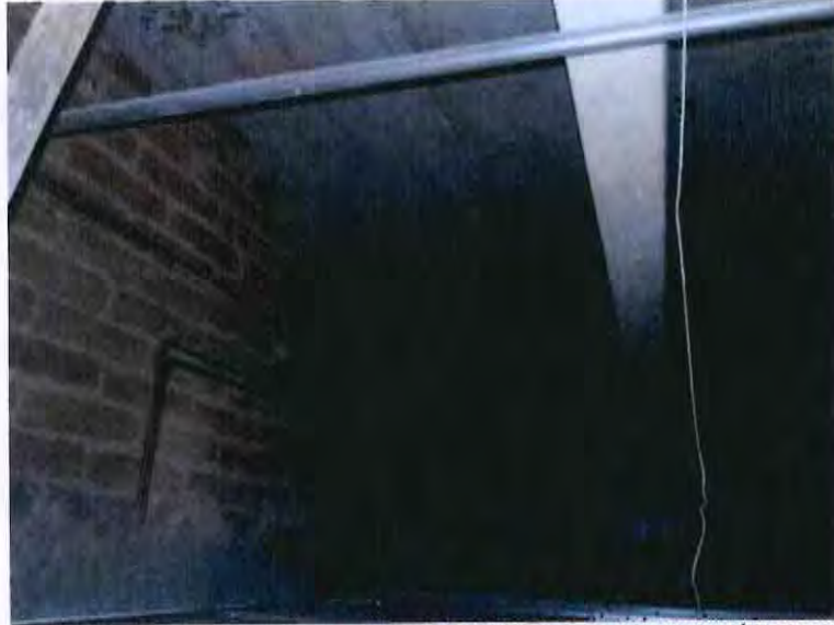
FOTOGRAFÍA 42. NO EXISTE TRABE NI MURO DE CONCRETO EN LA DIRECCIÓN CORTA EN LA COLINDANCIA.
