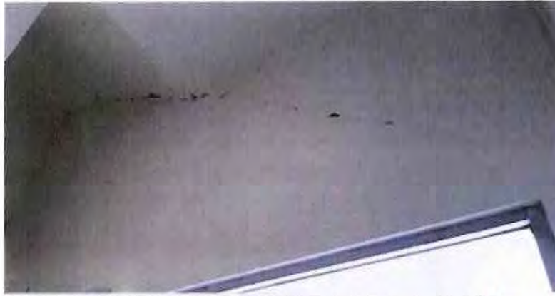
FOTOGRAFÍA 9. FISURA EN DIAGONAL EN MURO DE FACHADA EN LA ESCALERA DE PLANTA BAJA A NIVEL 1, QUE NACE EN UNIÓN CON LOSA DE ESCALERA.
