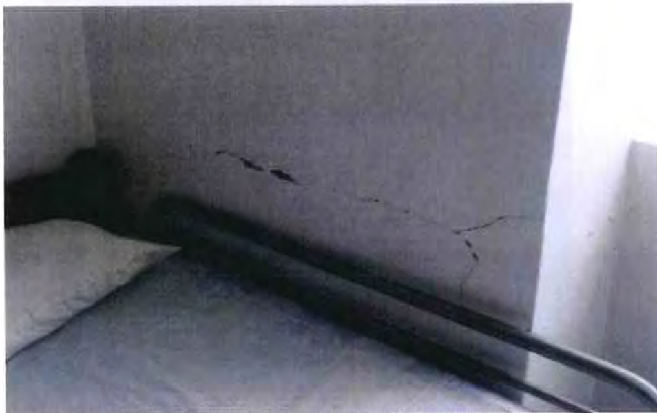
FOTOGRAFÍA 5. FISURA HORIZONTAL EN MURO DIVISORIO, EN JUNTA CON ELEVADORES.
