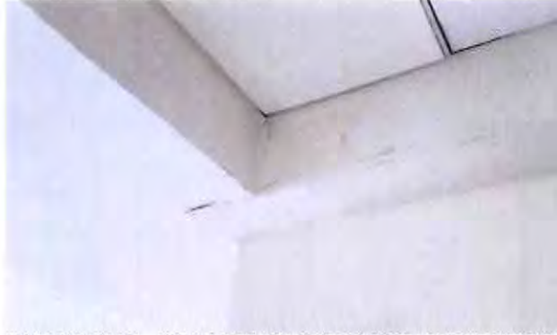
FOTOGRAFÍA 31. FISURAS EN PLAFONES Y ESQUINAS DE MUROS DIVISORIOS EN PLANTA BAJA.
