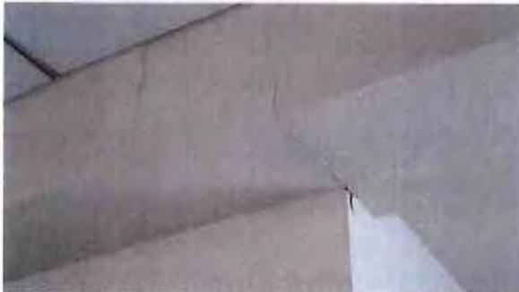
FOTOGRAFÍA 30. FISURAS EN PLAFONES Y ESQUINAS DE MUROS DIVISORIOS EN PLANTA BAJA.
