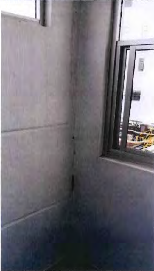
FOTOGRAFÍA 28. EN ZONA DE ESCALERA, DESCARAPELAMIENTO DE ACABADO EN UNIÓN DE MUROS DE FACHADA, FISURA QUE NACE EN VANO DE VENTANA.
