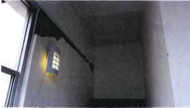
FOTOGRAFÍA 27. ESCALERA DE NIVEL 2 DESCARAPELAMIENTO DE ACABADO EN MURO DE FACHADA, FISURA EN ACABADO.
