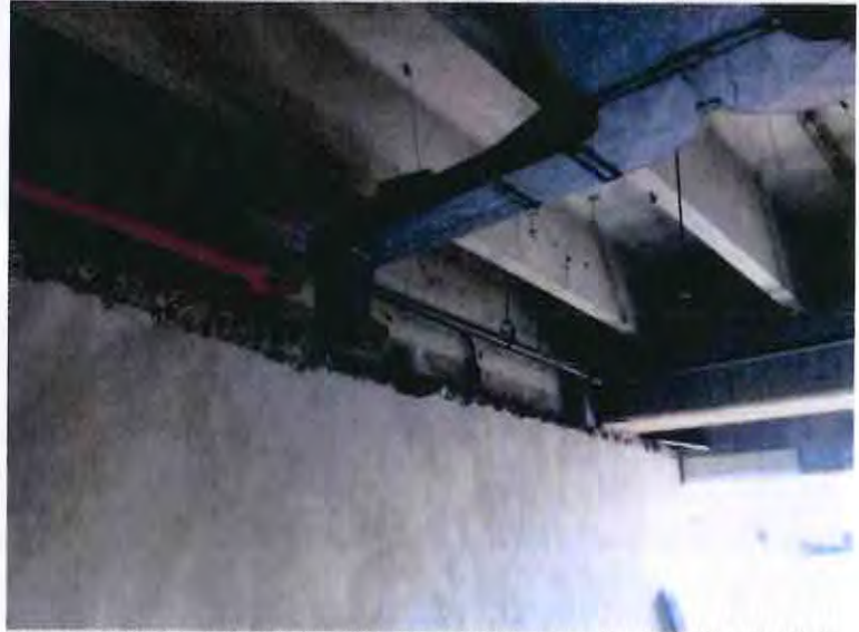
FOTOGRAFÍA 37. MURO DIVISORIO DESLIGADO DE LA ESTRUCTURA PRINCIPAL.
