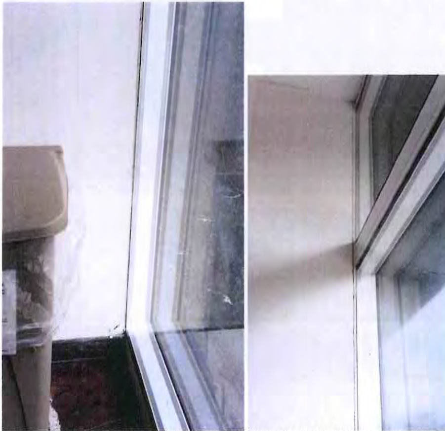
FOTOGRAFÍAS 32, 33. FISURAS VERTICALES EN ESQUINAS DE MUROS DIVISORIOS Y CANCELERÍA.
