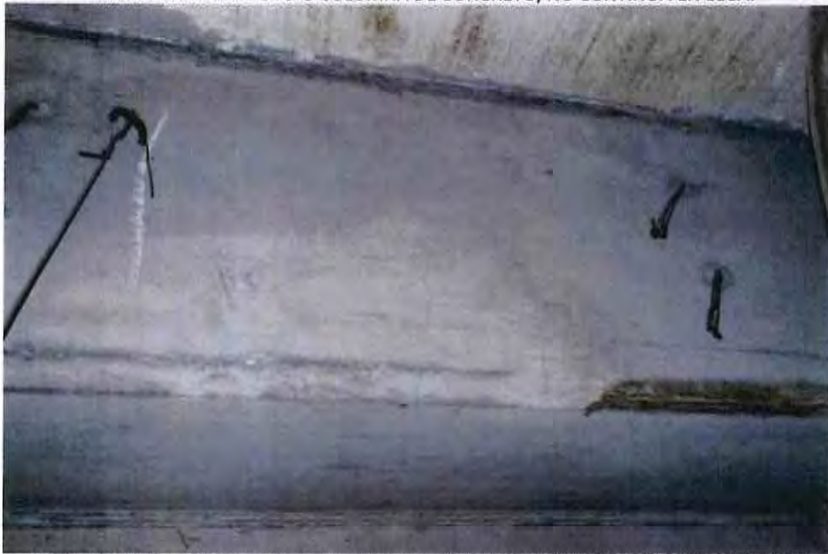
FOTOGRAFÍA 23. ESTRUCTURA PRINCIPAL CON FISURAS EN VERTICAL DE 1mm POR FLEXIÓN DE LA TRABE.
