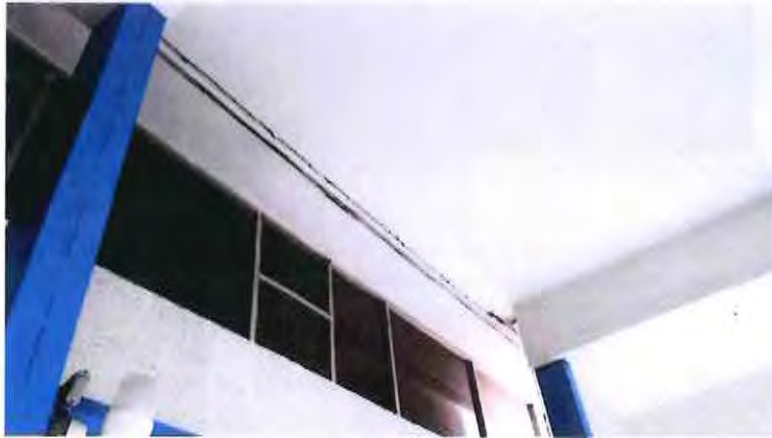
FOTOGRAFÍA 12. DESPRENDIMIENTO DE ACABADO EN JUNTA CONSTRUCTIVA CON LA TORRE BELTRÁN.
