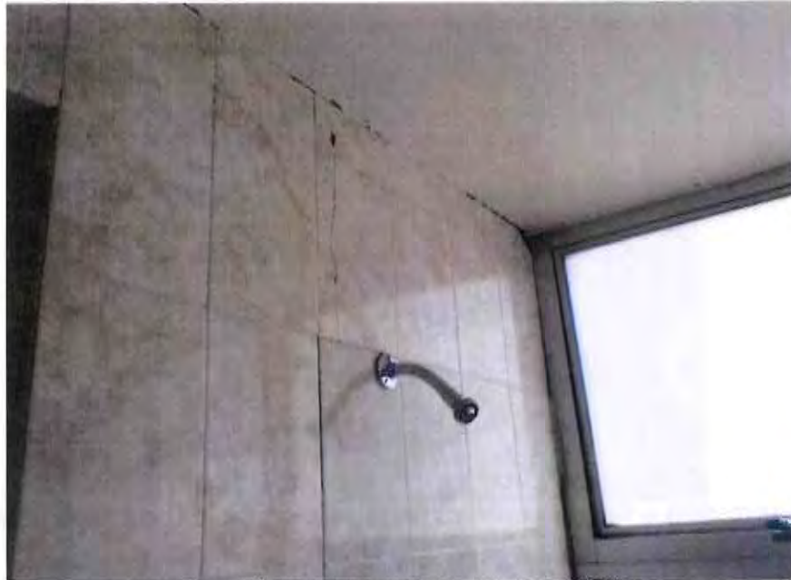
FOTOGRAFÍA 4. MURO DIVISORIO FISURADO EN BAÑO.
