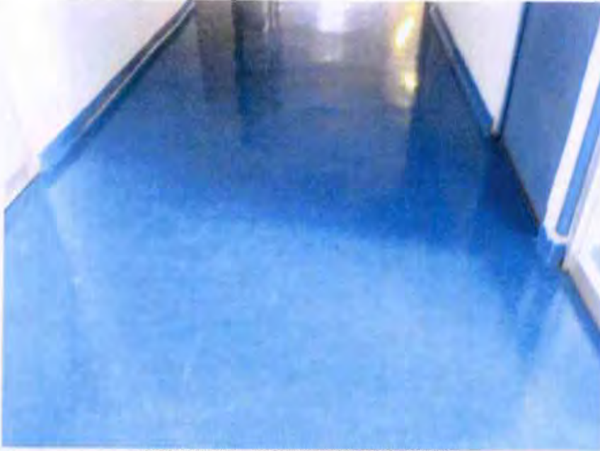
FOTOGRAFÍA 8. ENTREPISO CON INCLINACIÓN.
