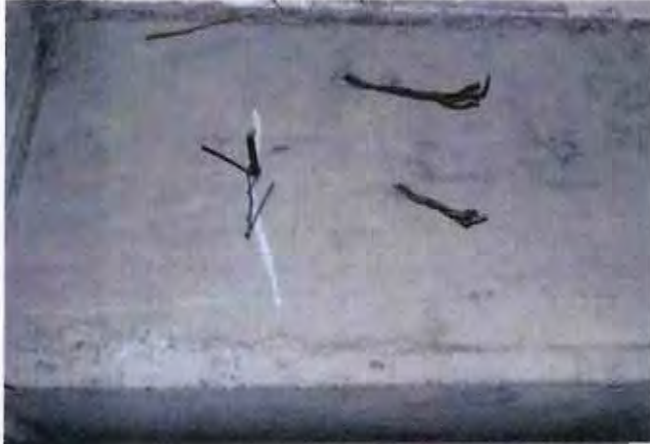
FOTOGRAFÍA 24. TRABE DE ESTRUCTURA PRINCIPAL CON FISURA EN VERTICAL DE 1mm CERCA DE LA COLUMNA DE CONCRETO.
