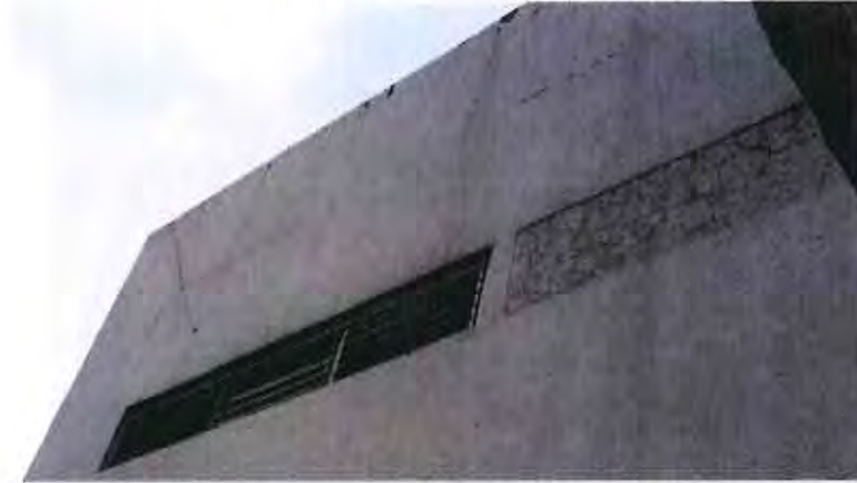
FOTOGRAFÍA 36 FACHADA EJE 8-D FISURAS HORIZONTALES EN UNIÓN DE PRETIL CON ELEMENTO ESTRUCTURAL Y FISURAS DE CONTRACCIÓN EN MURO PARA CERRAR VANO.
