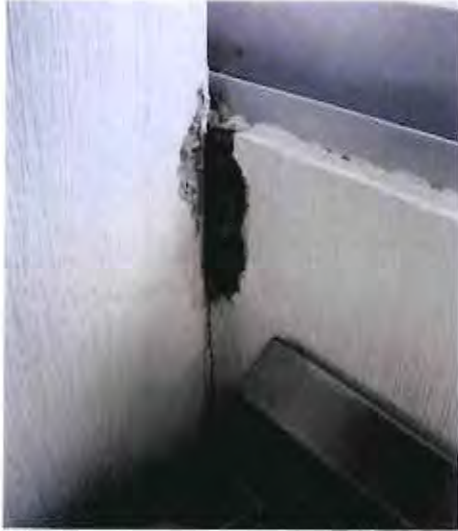
FOTOGRAFÍA 17. NIVEL 2 EJE 1G FISURA EN VERTICAL EN LA UNION DE MURO DIVISORIO CON ELEMENTO ESTRUCTURAL, SIN AFECTACIÓN DE LA ESTRUCTURA PRINCIPAL.
