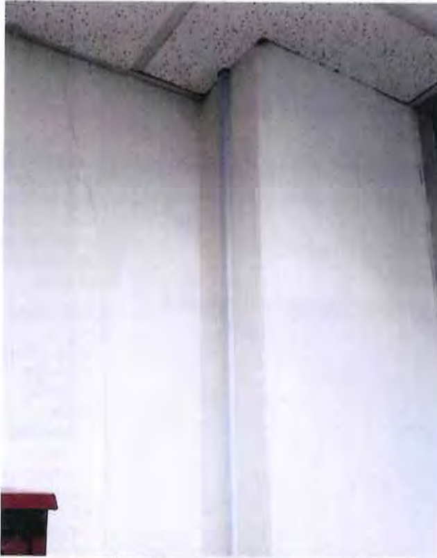
FOTOGRAFÍA 7. PLANTA BAJA EN EJE 6D COLUMNA EN BUEN ESTADO, SIN DEFORMACIÓN, NI DESPLOME, FISURA EN MURO DIVISORIO EN LA PARTE SUPERIOR.
