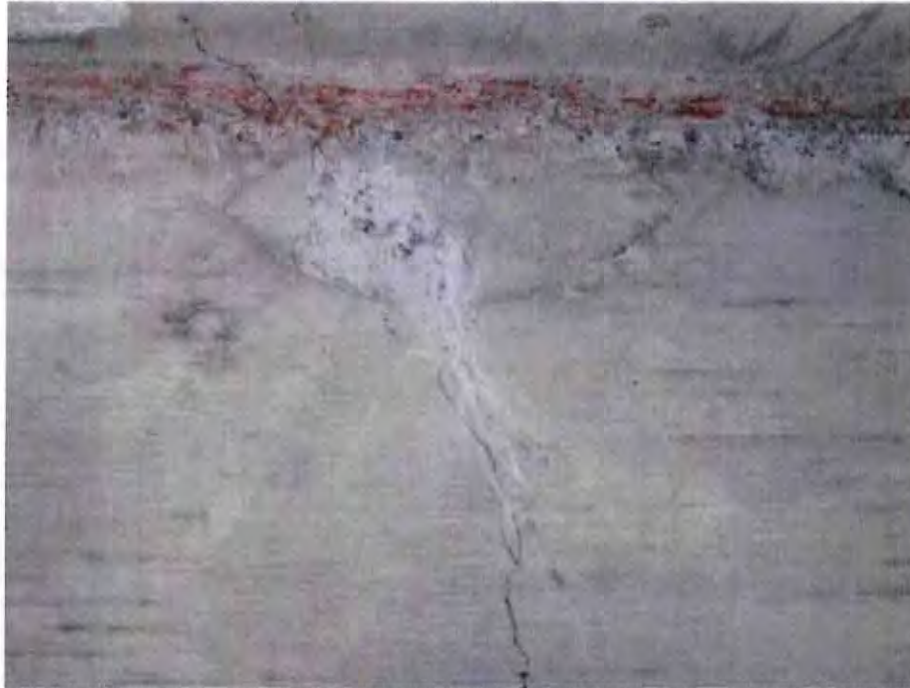
FOTOGRAFÍA 20. NIVEL 2. FISURA EN DIAGONAL DE 1mm EN TRABE DE ESTRUCTURA PRINCIPAL.
