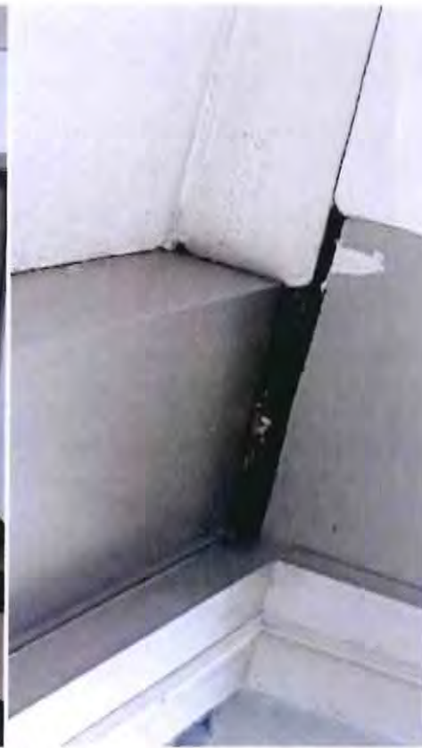
FOTOGRAFÍA 8. TRABE METÁLICA CON EVIDENTE CORROSIÓN.
