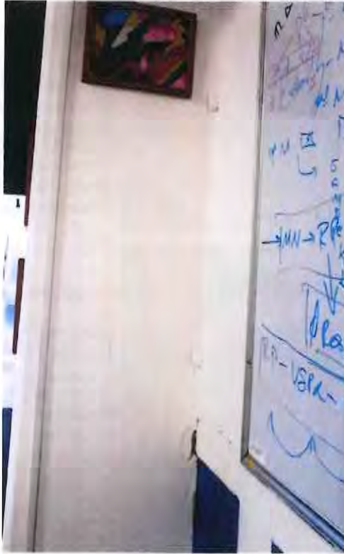
FOTOGRAFIA 12. NIVEL 1, EN EJE 8D. COLUMNA EN BUEN ESTADO SIN DEFORMACION, NI ALTERACION ESTRUCTURAL ALGUNA, FISURA EN VERTICAL EN LA UNION DE LA COLUMNA CON TRABE DE MURO DIVISORIO, SIN DAÑAR LA ESTRUCTURA PRINCIPAL.
