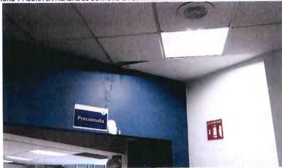
FOTOGRAFÍA 2. PLANTA BAJA. PLAFON EN MAL ESTADO Y DESCARAPELAMIENTO DE ACABADO EN ACCESO A PRECONSULTA.
