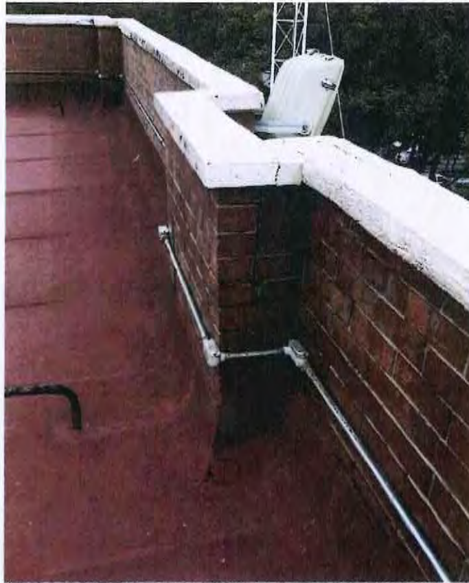
FOTOGRAFÍA 21. NIVEL DE AZOTEA. FISURA EN PRETEL Y REPISON DE CONCRETO.
