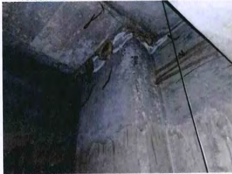
FOTOGRAFÍA 15. COLUMNA CON DESPRENDIMIENTO DE RECUBRIMIENTO EN LA PARTE SUPERIOR.
