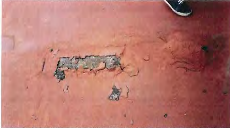
FOTOGRAFÍA 44. EN AZOTEA, EL IMPERMEABILIZANTE DE LA LOSA SE ENCUENTRA EN MAL ESTADO, LO CUAL PUEDE GENERAR EN HUMEDADES, QUE A LO LARGO PUEDE DAÑAR LA LOSA.
