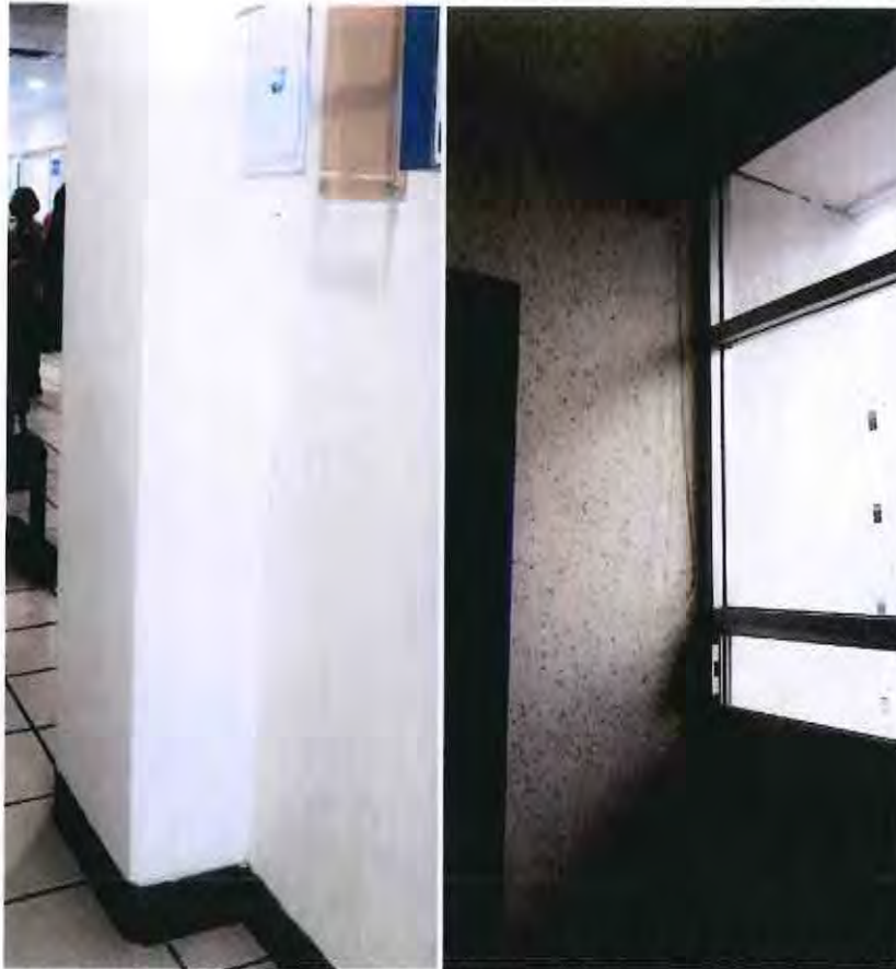
FOTOGRAFÍA 39. NIVEL 4 EJE 2-D, DESCARPELAMIENTO DE ACABADO EN UNIÓN DE MURO DIVISORIO Y COLUMNA DE ESTRUCTURA PRINCIPAL, QUE SE ENCUENTRA EN BUEN ESTADO.
