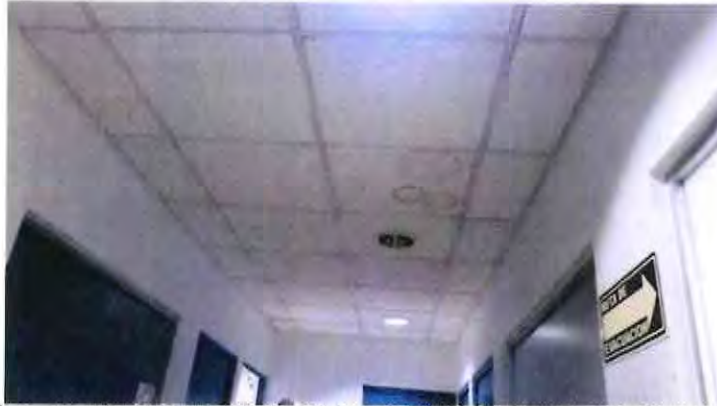
FOTOGRAFÍA 3. PLAFÓN CON HUMEDAD, PERO SIN DAÑOS APARENTES DEBIDO AL SISMO.
