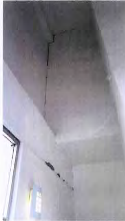
FOTOGRAFIA 42. NIVEL 4 DESCARPELAMIENTO DE ACABADO EN TRABE DE ESTRUCTURA PRINCIPAL, Y FISURA VERTICAL EN UNIÓN DE MUROS DE AZOTEA.
