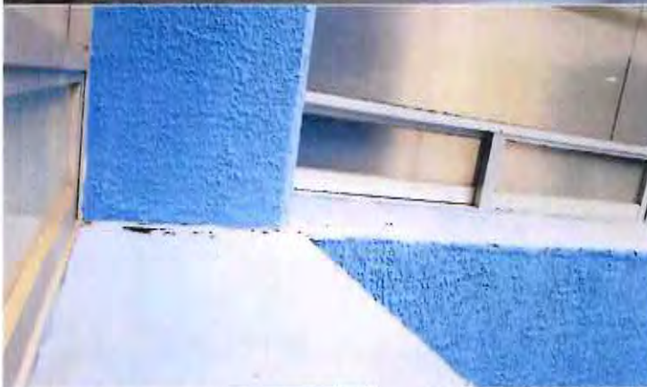
FOTOGRAFÍA 30. NIVEL 3 EN EJE 6-I DESCARAPELAMIENT TO DE ACABADO EN TRABE LOSA DE PRETIL.
