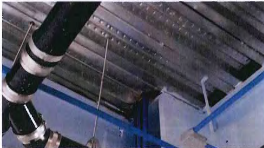
FOTOGRAFÍA 27. INTERRUPCIÓN DEL APOYO DEL SISTEMA DE LOSACERO EN TRABE POR PASO DE INSTALACIONES.
