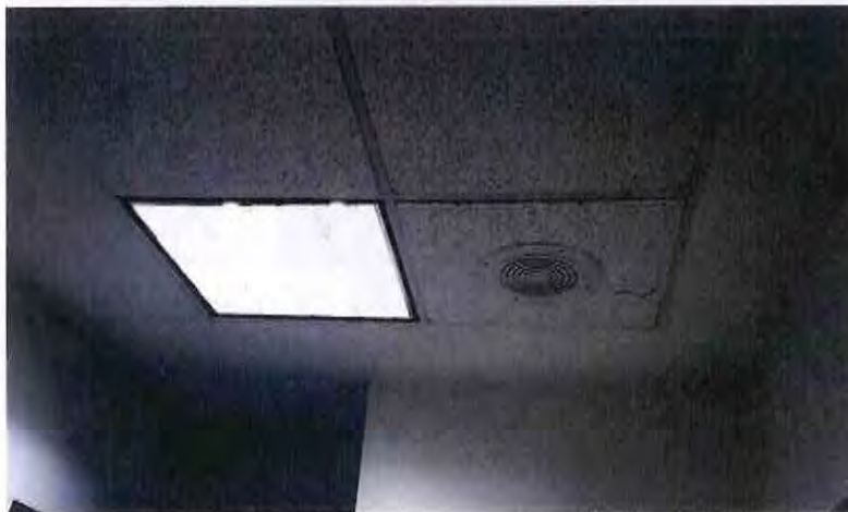
FOTOGRAFÍA 11. NIVEL 1 EJE 6D. MUROS EN BUEN ESTADO, PLAFONES CON FISURA, SIN DAÑAR ESTRUCTURA PRINCIPAL.
