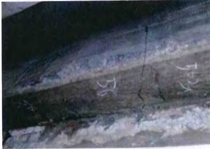
FOTOGRAFÍA 34. TRABE SIN RECUBRIMIENTO EN ESQUINA INFERIOR.
