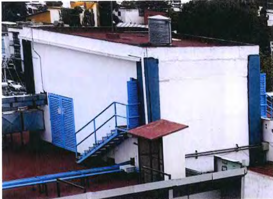
FOTOGRAFÍA 17. EN SOBREPASO EN AZOTEA, SE OBSERVAN FISURAS HORIZONTALES EN EL ACABADO EN TRABES.
