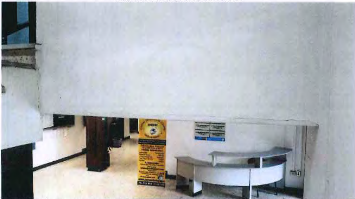
FOTOGRAFÍA 20. JUNTA CONSTRUCTIVA CON EDIFICIO 9, FISURA HORIZONTAL EN ACABADO DE MURO Y HORIZONTAL EN LA UNIÓN CON LA ESCALERA.
