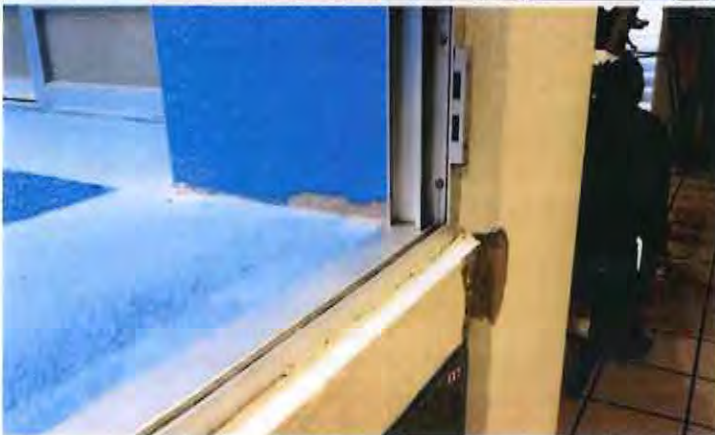
FOTOGRAFÍA 19. NIVEL 2 EJE 6-G DESCARAPELAMIENTO DE ACABADO EN COLUMNA DE ESTRUCTURA PRINCIPAL, FISURA EN ACABADO EN UNIÓN DE TRABE DE PRETEL Y CANCELERÍA.
