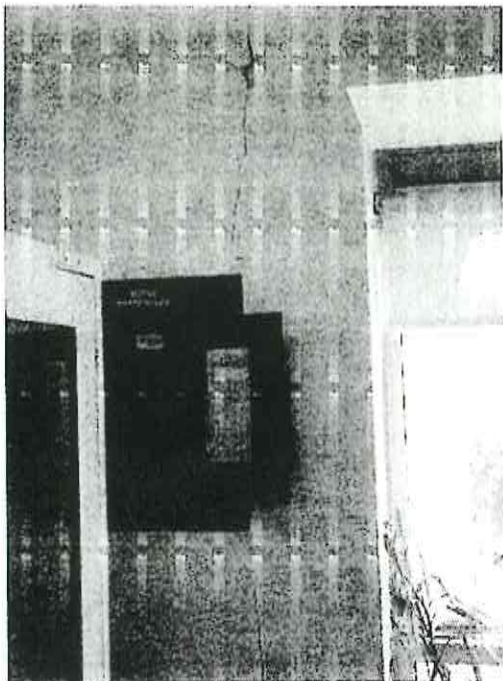
FOTOGRAFÍA No. 18: Fisuras de instalaciones sin problemas estructurales.
