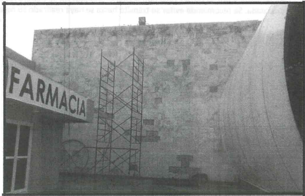
Desprendimiento de los acabados, lajas de cantera.
