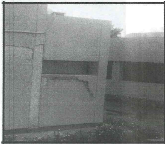
Fisura en muro divisorio.
