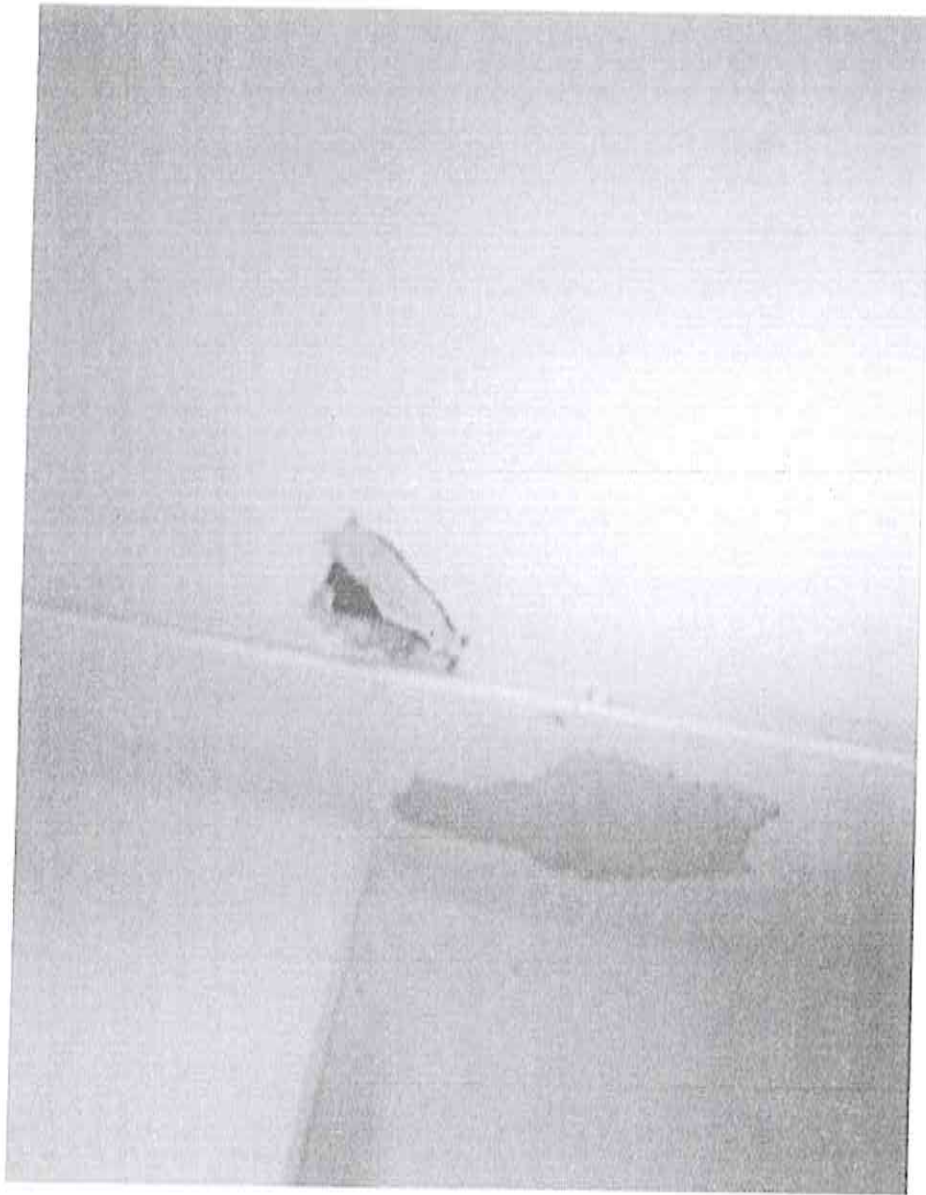
DESPRENDIMIENTO DE APLANADO DEL PLAFÓN SIN DAÑO EN COLUMNAS
