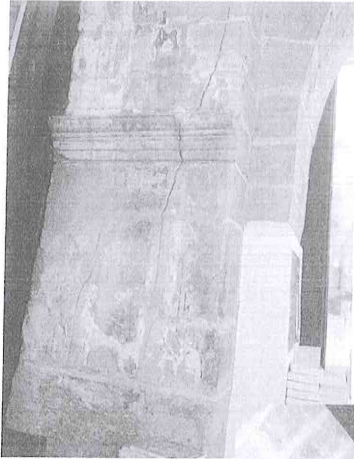
FISURAS EN COLUMNA DE CANTERA EN LA ESQUINA INTERIOR DEL EDIFICIO
