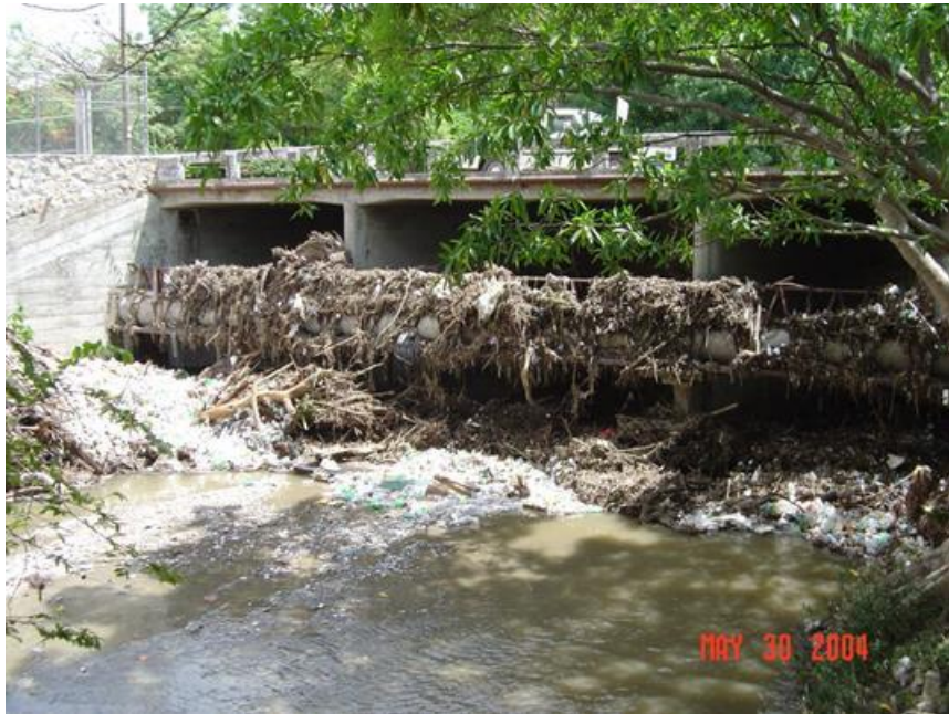
Obstrucción por tubería y basura
