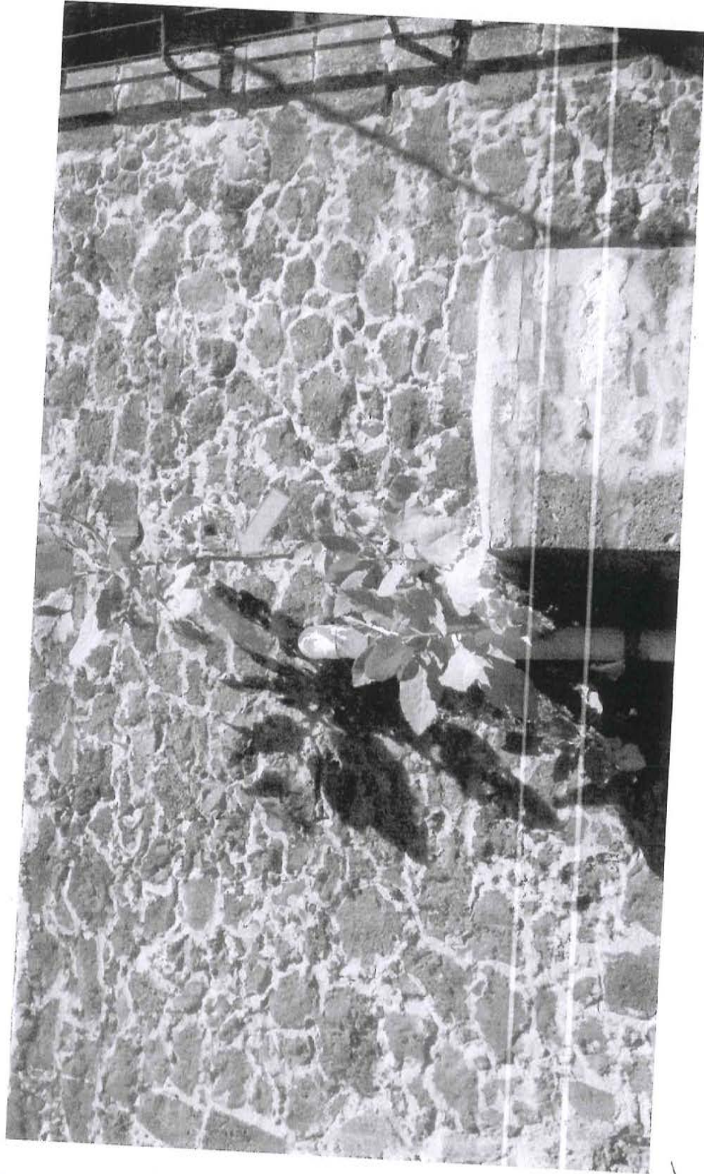
Fotografía 26.- En el muro de colindancia sur de la capilla hay grietas que es necesario reparar para evitar el deterioro por el ingreso de lluvia. No sabemos si fue consecuencia de los sismos recientes o estaban antes de septiembre ya que para revisar es necesario entrar por la propiedad vecina.
