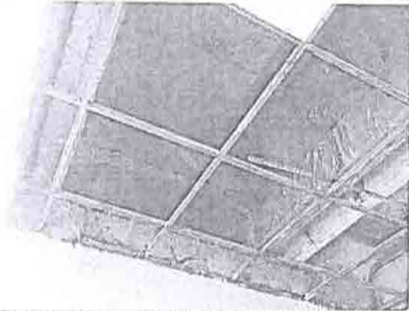
FOTOGRAFIA 10. ARMADURA EN FACHADA PRINCIPAL (PLANTA BAJA) SIN APARENTES DAÑOS O ALGUNA DEFORMACIÓN LOCAL.
