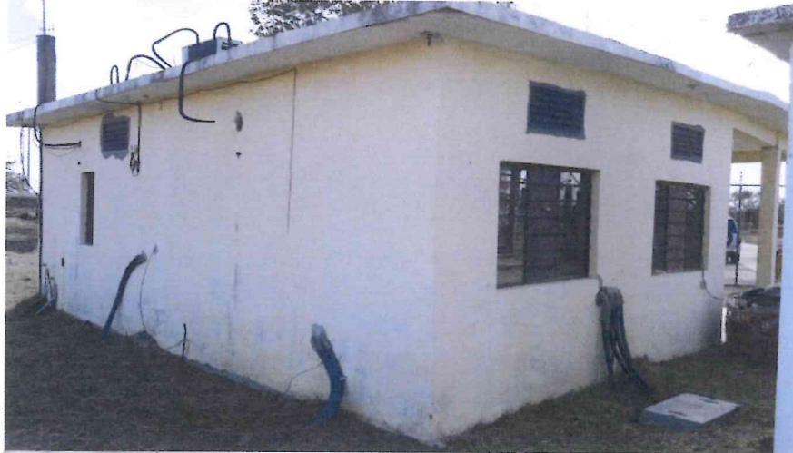
CUARTO DE BATERÍAS
