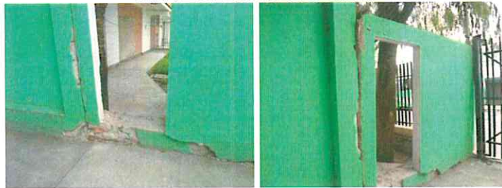
ANTES: Barda afectada.
