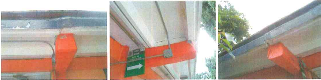
ANTES: Losa afectada.
