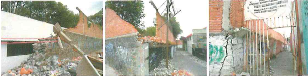
ANTES: Bardas afectadas.
