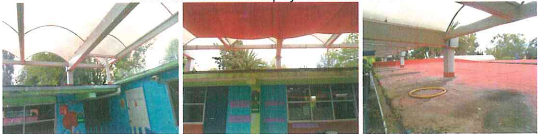
ANTES: Estructura apoyada sobre aulas.
