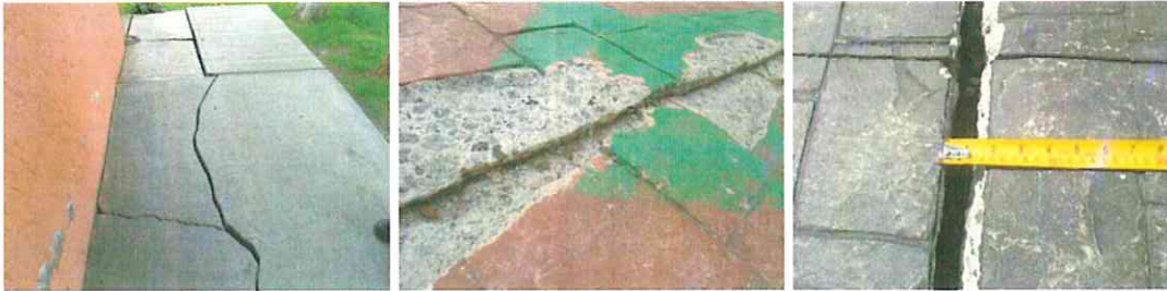
ANTES: Firmes afectados.
