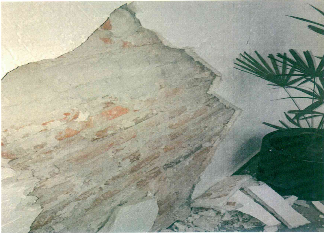
FOTO 3. DESPRENDIMIENTO DE YESO EN COLINDANCIA NORTE. MUY GRUESO.
