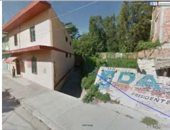
Figura 4-4. Obstrucción y reducción del área hidráulica en arroyo Colorado, sobre calle Emiliano Zapata, Abasolo.
