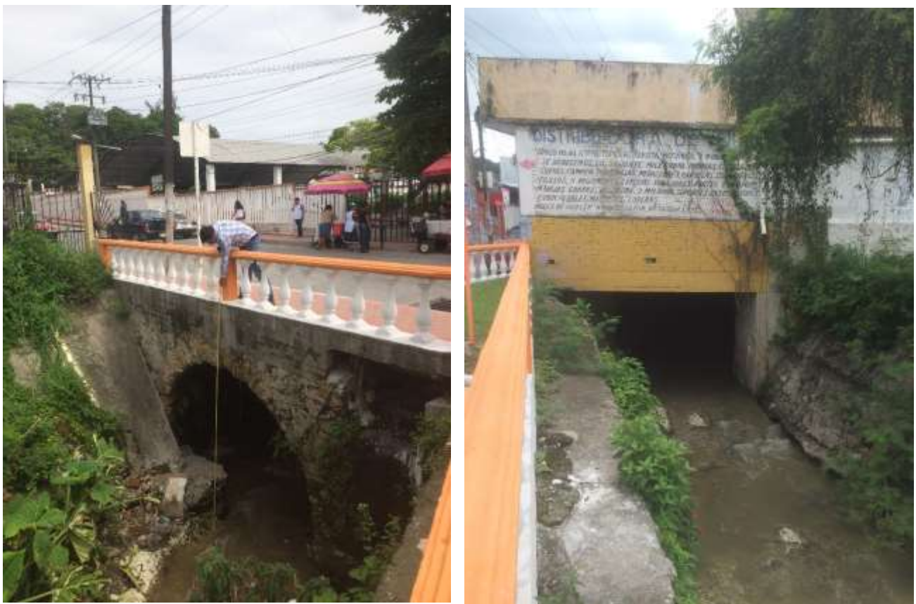
Figura 4-2 Asentamientos humanos sobre cauce federal
