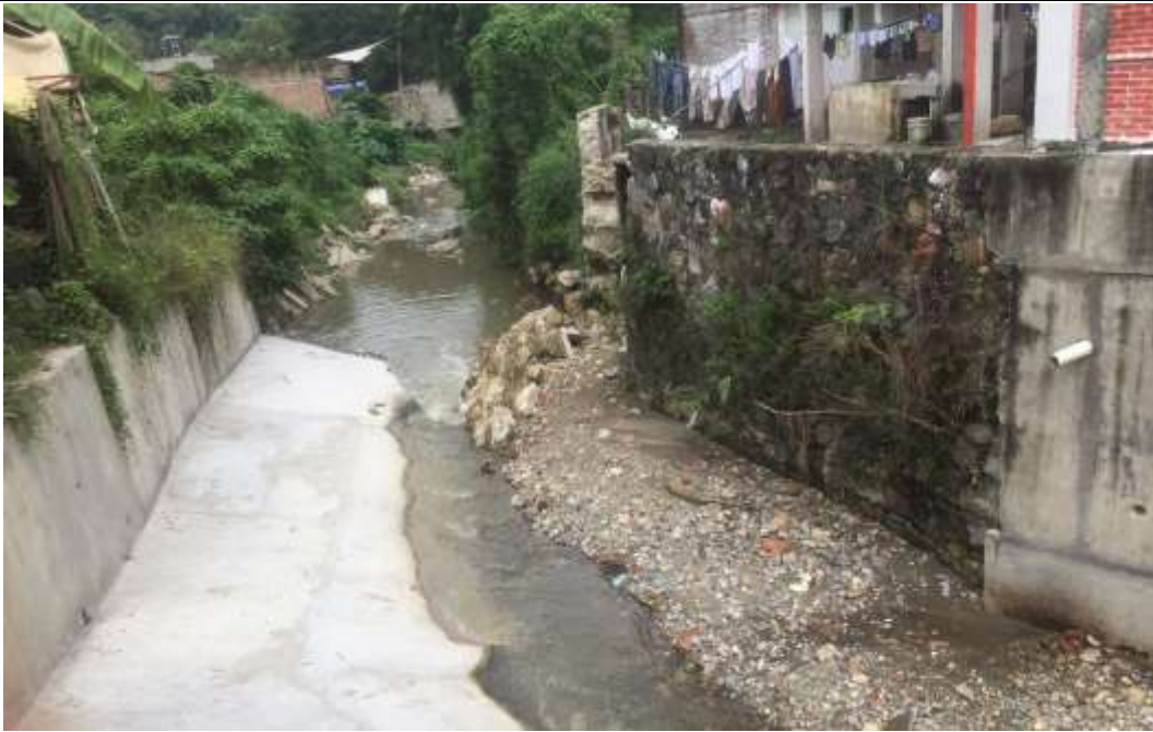
Figura 4-3 Modificación del área hidráulica del cauce por presencia de asentamientos humanos
