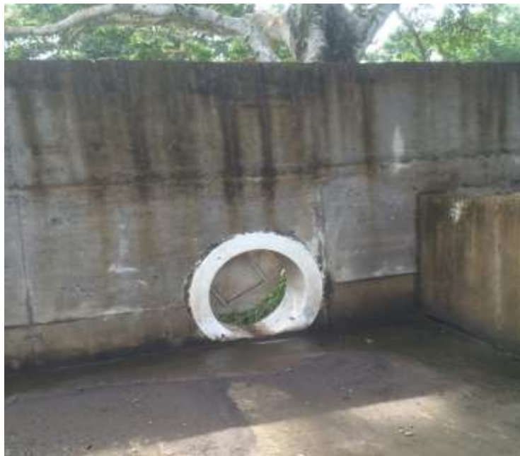
Figura 4-5 Estado de las compuertas en muro perimetral
