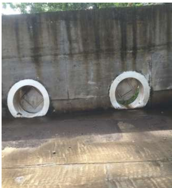
Figura 4-6 Estado de las compuertas en muro perimetral
