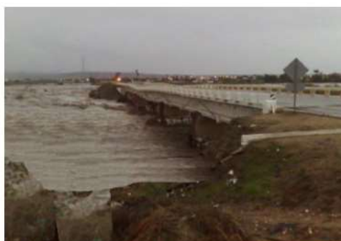
Foto 26- Evidencia de la falla del Puente Santo Domingo y la amplia crecida del lecho del arroyo Colonia Vicente Guerrero.
