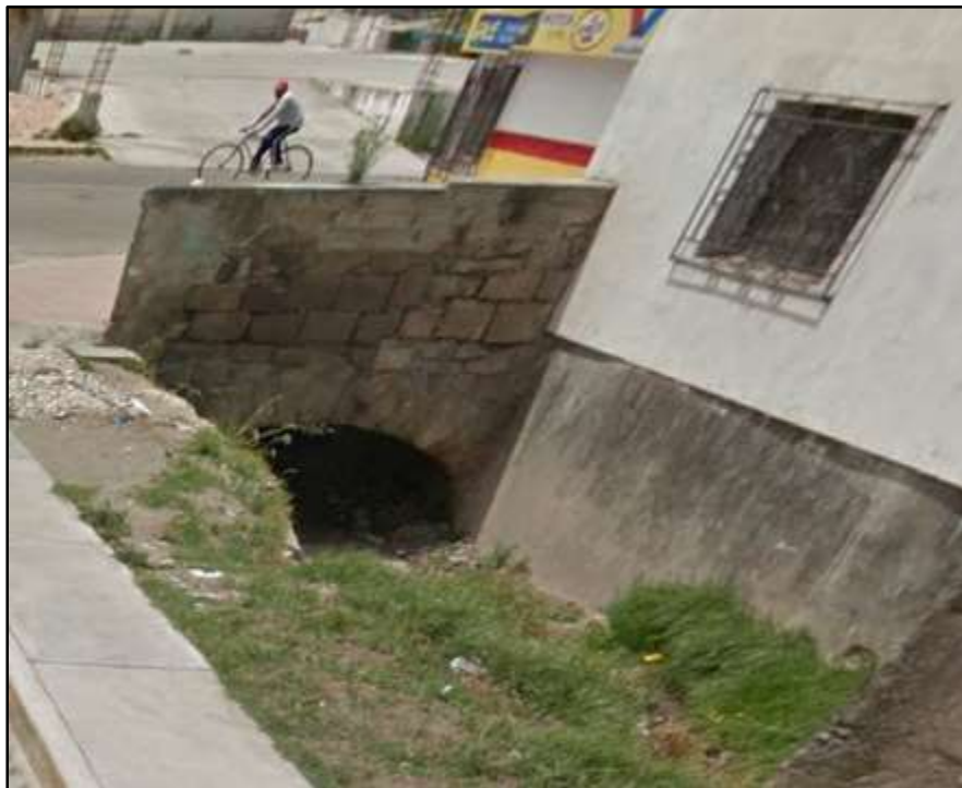
Figura 5.10 Inicio de alcantarilla en el cruce de Úrsulo Galván y niño Artillero
