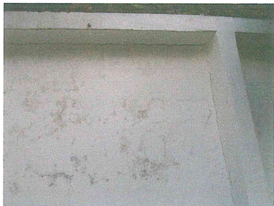
Foto 36. Fisura en barda de colindancia que no representa ningún riesgo estructural. Se recomienda su sellado.
