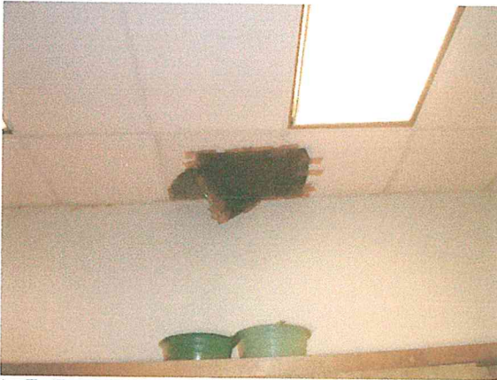
Foto 7. Evidencia de la problemática de filtración de agua pluvial en la Dirección de Profesionalización.
