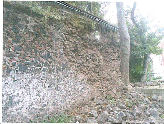
Foto 12. Barda de colindancia, derruida parcialmente durante el sismo.
