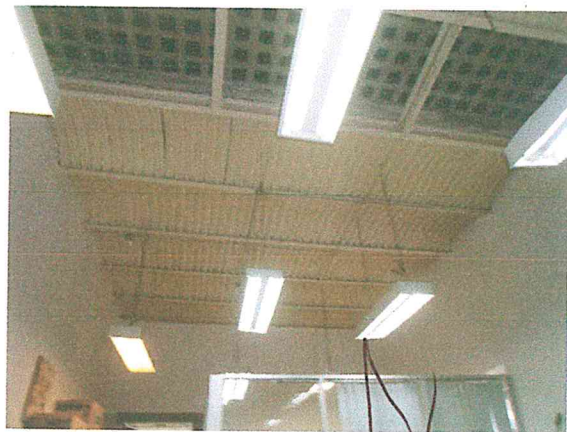
Foto 14. Vigüeta y bovedilla y techumbre con vitro block, en buen estado estructural.
