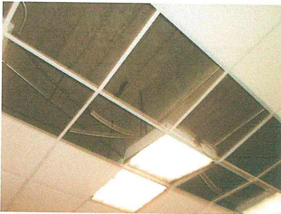
Foto 11. Losa de concreto, en buen estado y suspensión de plafón modular, deformada por el sismo.
