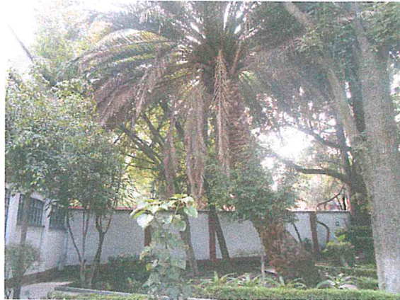
Foto 12. Palmera en peligro de caer sobre el edificio C. se recomienda su tala.
