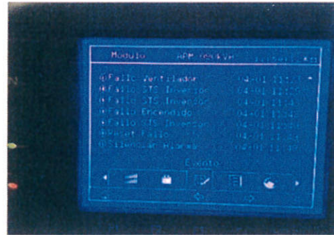
Registro de falla en STS Inversor y falla de ventilador
