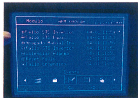
Daño registrado en el STS Inversor del módulo de 15 KVA Daño registrado en el STS BYPASS de mismo modulo.
