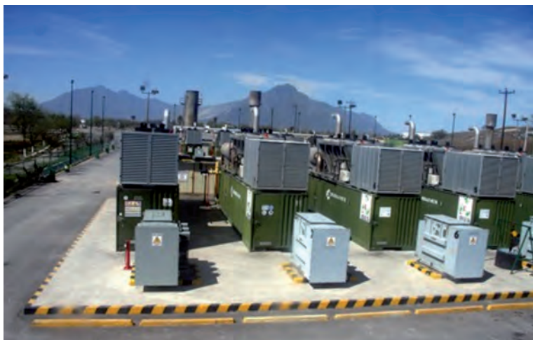
Figura 7.1. Fotografía del paquete de generación (cortesía BENLESA).
