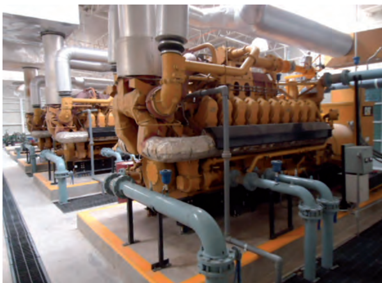
Figura 7.6. Fotografía de los motogeneradores (cortesía Biogás de Juárez).
