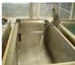
Tina de tratamiento hidrotérmico
