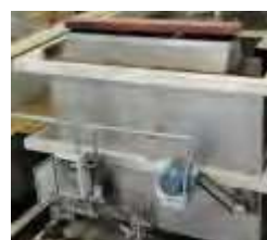
Sistema de calefacción de agua
