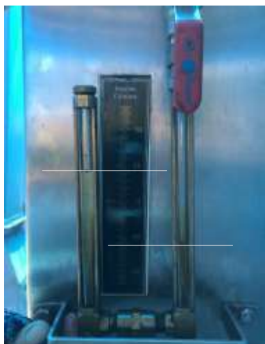
Imagen 4. Manómetro de brazo abierto cuya imagen muestra lo siguiente: al momento de inyectar presión a la cámara de fumigación, el líquido se mueva a -31mm del brazo cerrado y a +21mm del brazo abierto. En este caso, el equipo no es funcional para realizar la prueba de hermeticidad, que el líquido debería bajar a -25mm del brazo cerrado y subir a +25mm del brazo abierto.
