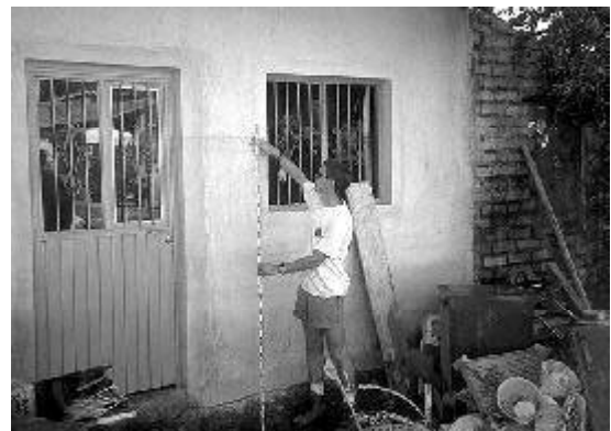
Fig. 26. Daños registrados por el tsunami local del 9 de octubre de 1995.
