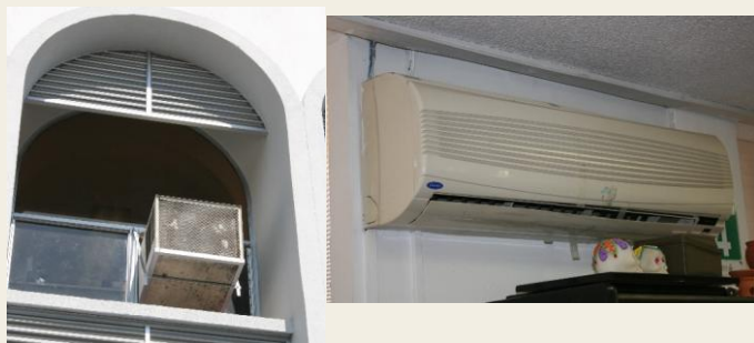
Sistema actual de aires acondicionados.
