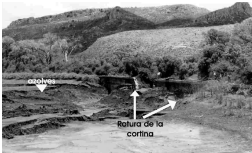
Fig. 34. Falla de la presa El Capulín . Vista de los azolves (Bitrán, 2003).
