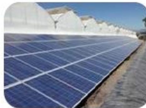
Fotovoltaicos Interconectados a Red
