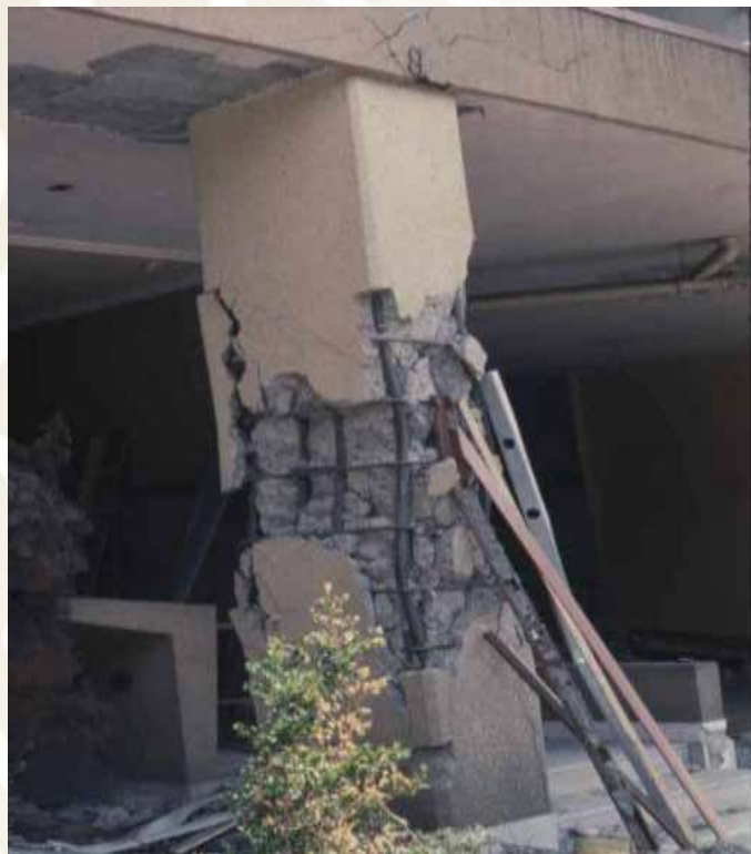
Daños producidos por carga axial en columna.
