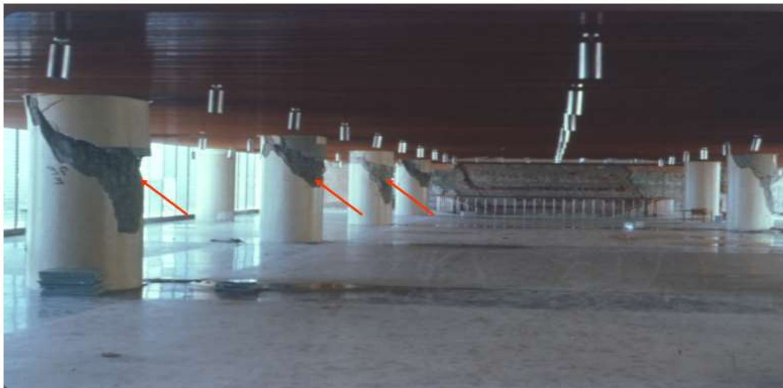
Daños producidos por esfuerzo cortante en columnas del primer piso
