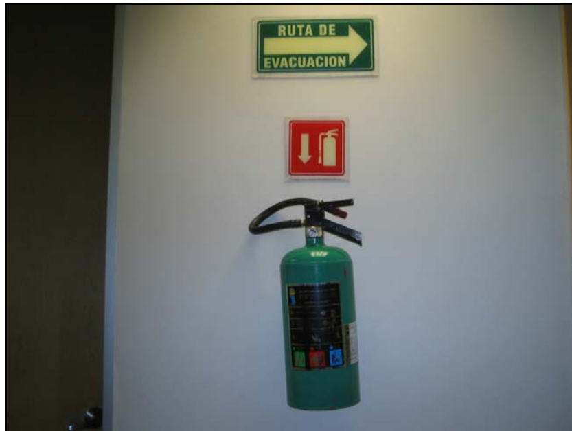
Interior del 2º. Piso extintor de polvo químico con señalamientos y rutas de evacuación
