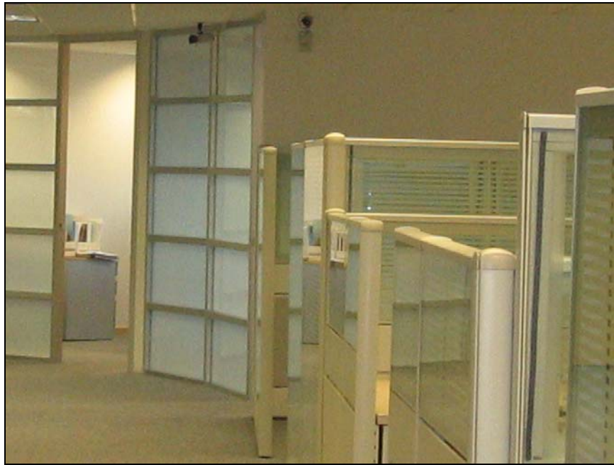
Interior de oficinas se observan CCCTV
