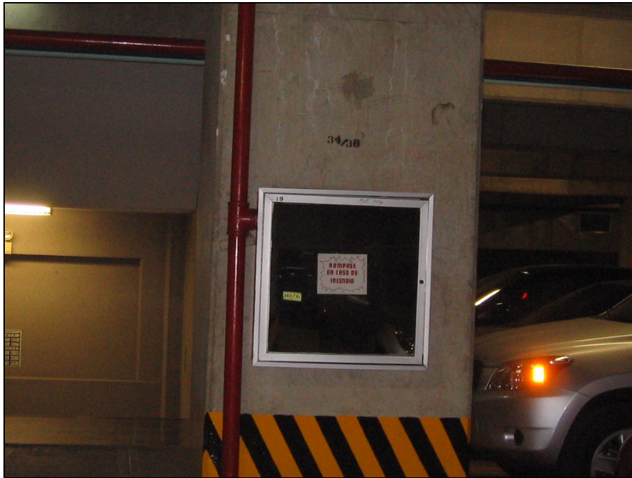
Hidrantes en sótano de estacionamiento de autos funcionarios
