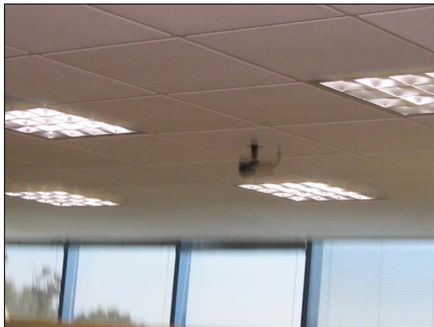
Se observa en el interior de las oficinas cámara de circuito cerrado.
