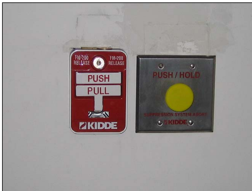
Alarma manual contra incendio FM200 en área de sistemas
