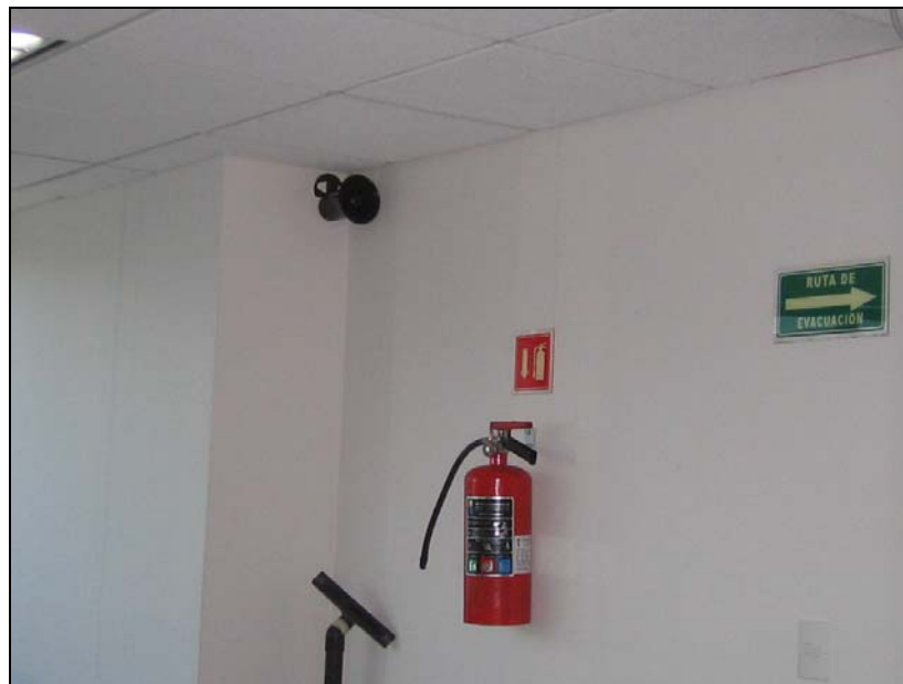
En muro alarma de pánico y extintor de gas halon con señalamientos de rutas de evacuación
