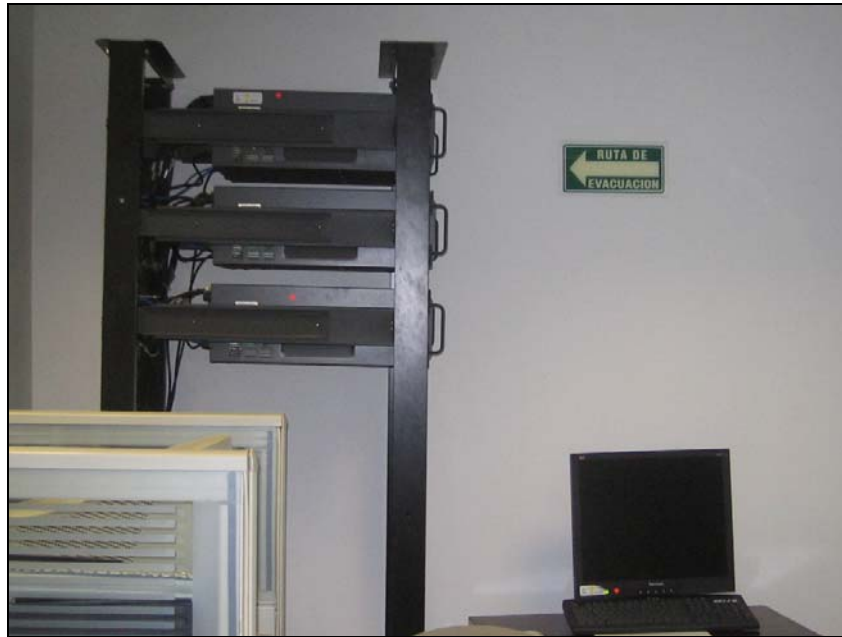
Equipo de CCCTV en el 2º. Piso
