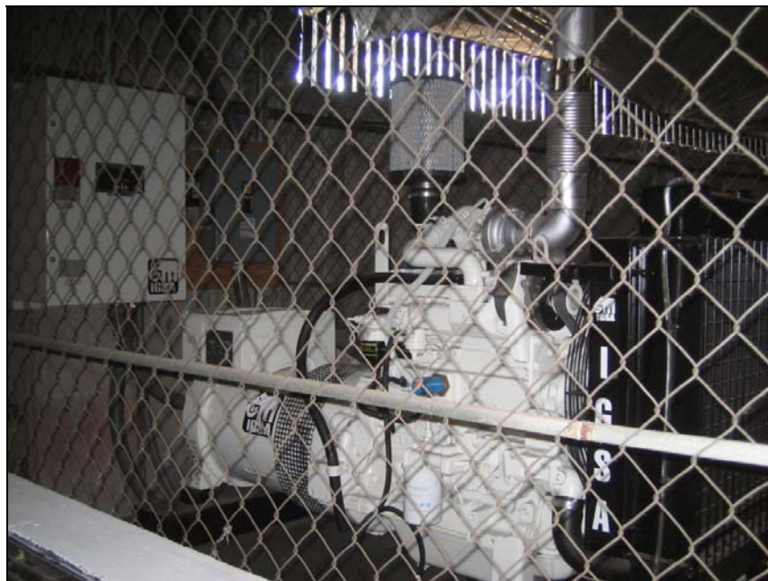
Planta de luz en sótano de 100 Kva.
