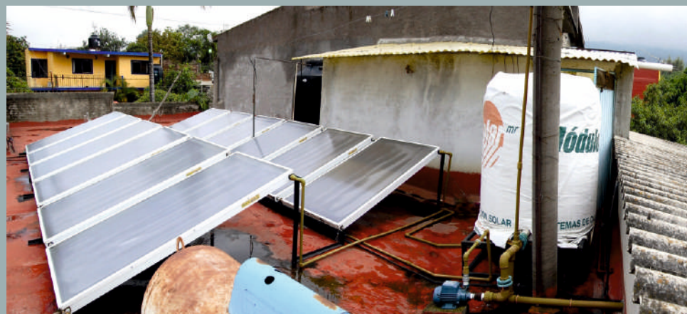
Sistema de calentamiento solar de agua: a la derecha el termotanque y a la izquierda los calentadores solares.
