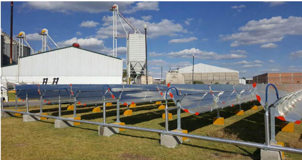
IMAGEN 13. CONCENTRADORES SOLARES POWER TROUGH 110
