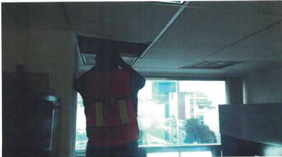
COLOCACIÓN DE PUNTO DE CONTROL Colocación de punto de control NIVEL 4-C2 bajo trabe.
