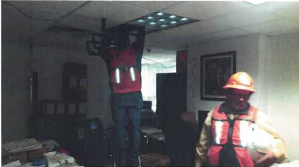
COLOCACIÓN DE PUNTO DE CONTROL Colocación de punto de control NIVEL 4-D5 bajo trabe.
