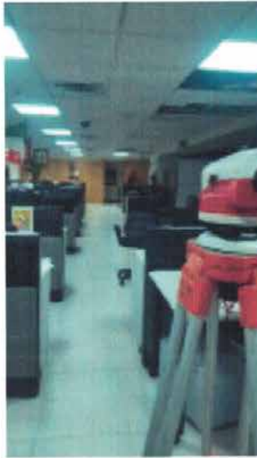
NIVELACIÓN DE PUNTO DE CONTROL Nivelación de punto de control NIVEL 2-C3 bajo losa.
