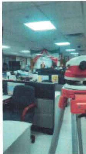
NIVELACION DE PUNTO DE CONTROL Nivelación de punto de control NIVEL 2-C4 sobre piso.
