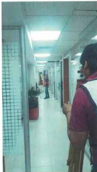
NIVELACIÓN DE PUNTO DE CONTROL Nivelación de punto de control NIVEL 6-E4 bajo losa.
