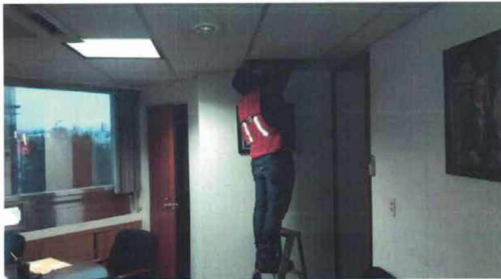
COLOCACIÓN DE PUNTO DE CONTROL Colocación de punto de control NIVEL 4-C5 bajo trabe.
