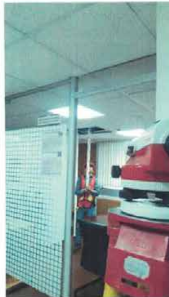
NIVELACIÓN DE PUNTO DE CONTROL Nivelación de punto de control NIVEL 6-B2 bajo losa.
