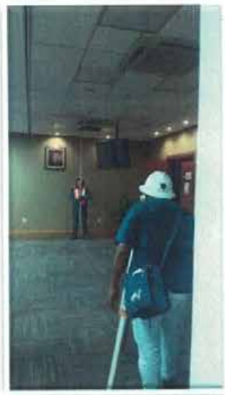
NIVELACIÓN DE PUNTO DE CONTROL Nivelación de punto de control NPB-C1 bajo losa.
