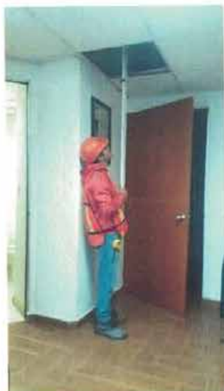
NIVELACIÓN DE PUNTO DE CONTROL Nivelación de punto de control NIVEL 9-E5 bajo losa.
