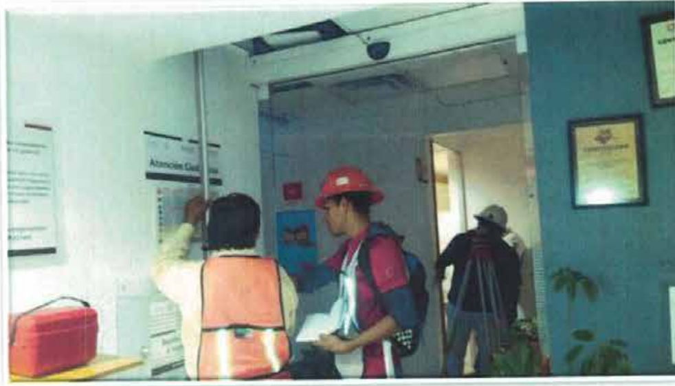
NIVELACIÓN DE PUNTO DE CONTROL Nivelación de punto de control NPB-C4 bajo trabe
