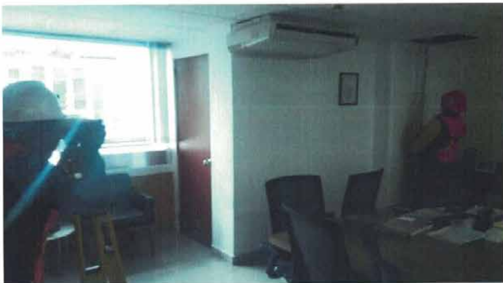
NIVELACIÓN DE PUNTO DE CONTROL Nivelación de punto de control NIVEL 7-D5 bajo losa.
