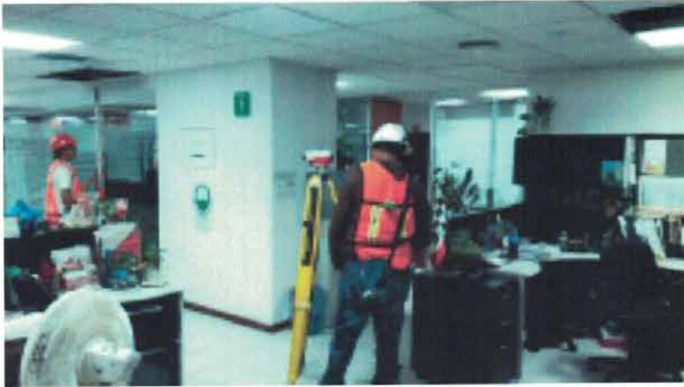
NIVELACIÓN DE PUNTO DE CONTROL Nivelación de punto de control NIVEL 1-C4 sobre piso.
