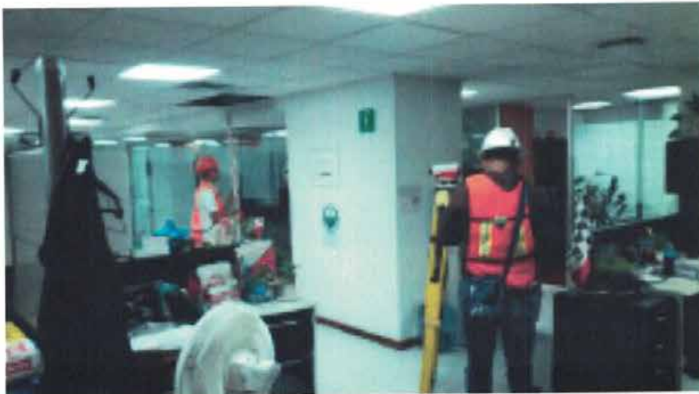
NIVELACIÓN DE PUNTO DE CONTROL Nivelación de punto de control NIVEL 1-C4 sobre piso.
