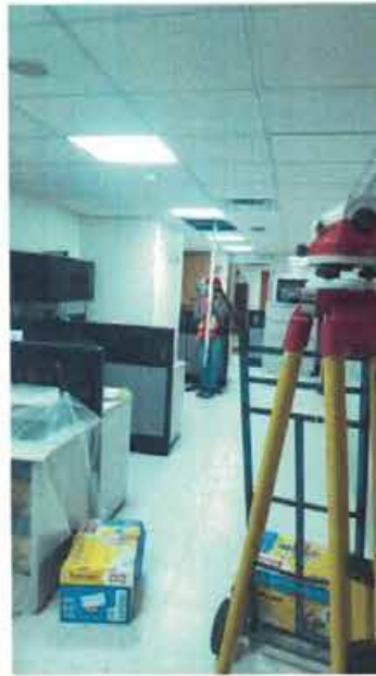
NIVELACIÓN DE PUNTO DE CONTROL Nivelación de punto de control NIVEL 6-C3 bajo losa
