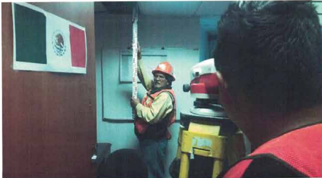
NIVELACIÓN DE PUNTO DE CONTROL Nivelación de punto de control NIVEL 4-E2 bajo losa.
