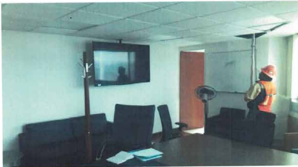
NIVELACIÓN DE PUNTO DE CONTROL Nivelación de punto de control NIVEL 8-B5 bajo losa.
