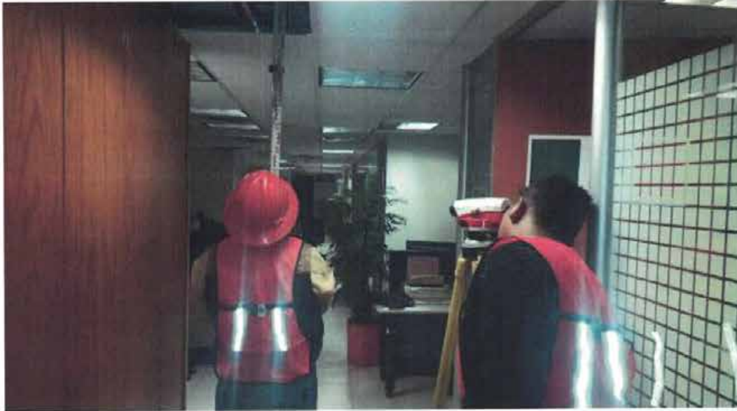
NIVELACIÓN DE PUNTO DE CONTROL Nivelación de punto de control NIVEL 4-E3 bajo losa.
