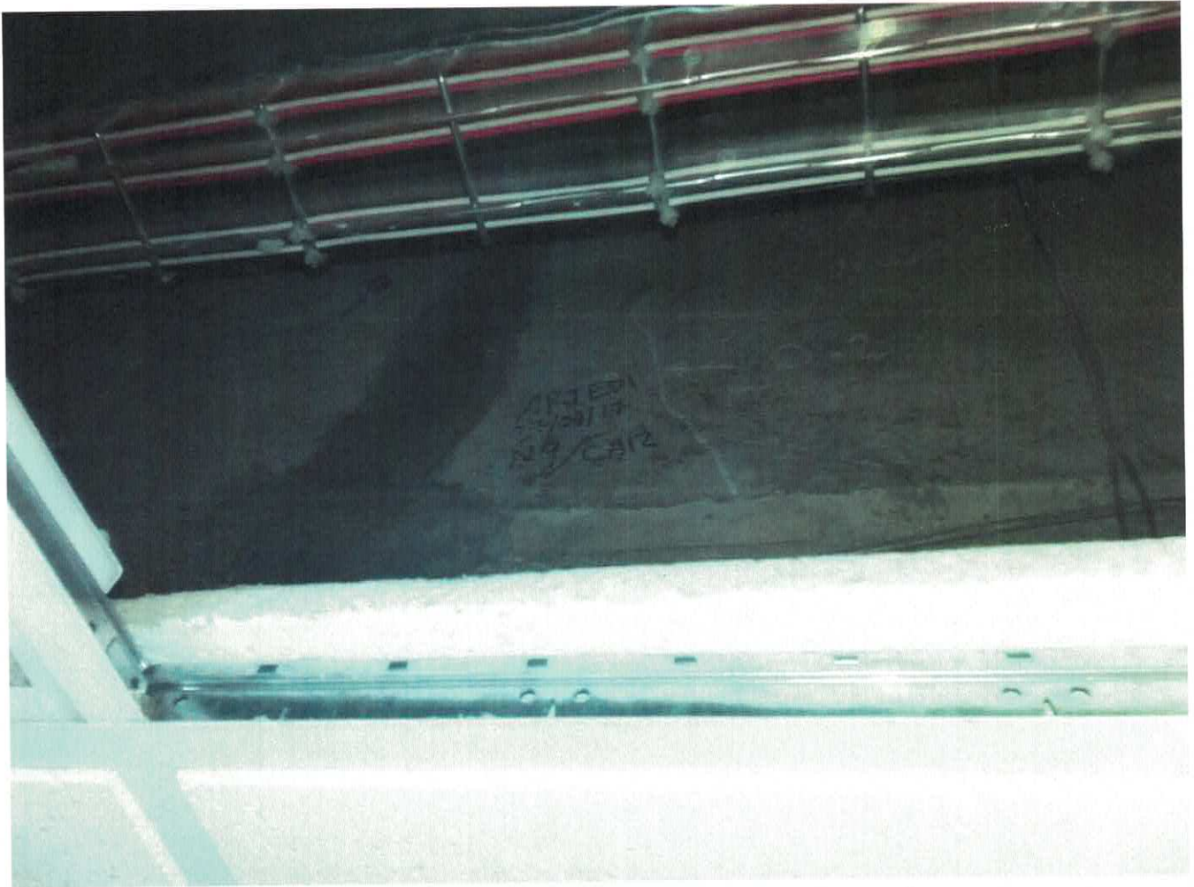
CALA No. 12, REALIZADA EN TRABE DE 25 cm. DE ANCHO POR 60 cm. DE PERALTE, DONDE SE OBSERVA LA CALA REPARADA CON MORTERO CEMENTO-ARENA Y ESTABILIZADOR DE VOLUMEN, LOCALIZADA EN NIVEL 9 SOBRE EL EJE (3') ENTRE LOS EJES (C-D)
