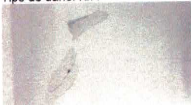
Fisura en recubrimiento Tipo de daño: FORMA
