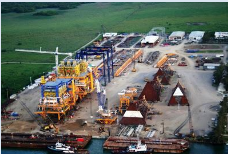
Vista general de las instalaciones Imagen obtenida de la página web de la empresa
