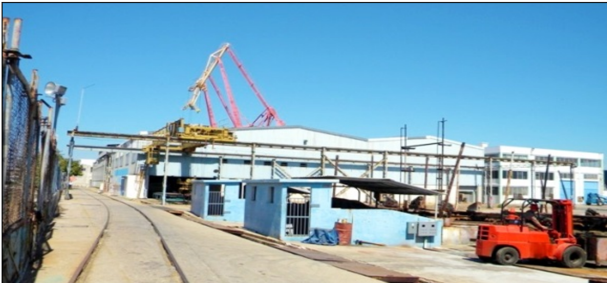
IMAGEN 70: PANORÁMICA DEL PARQUE DE MATERIALES, DEL TALLER DE ELABORACIÓN Y DEL TALLER DE TUBERÍA
