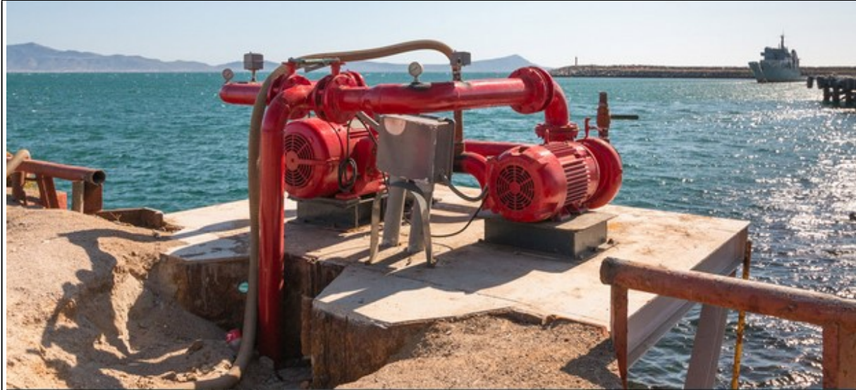
IMAGEN 34: BOMBAS DE ACHIQUE DEL DIQUE SECO.
