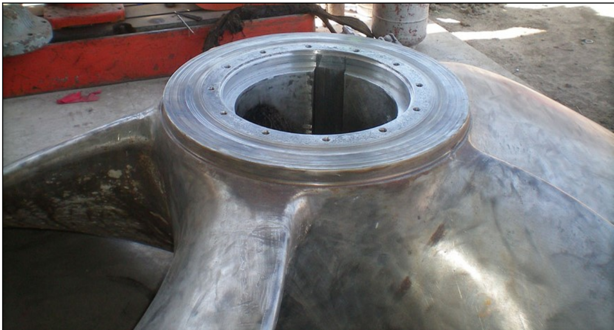
IMAGEN 27: REPARACIÓN DE HÉLICE
