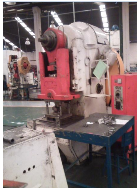
Ilustración 76 Falta de seguridad en máquinas
