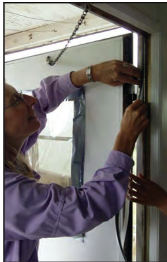
Un contratista de Viva Verde instala material aislante en el marco de la puerta de una casa del sur de Nuevo México.
