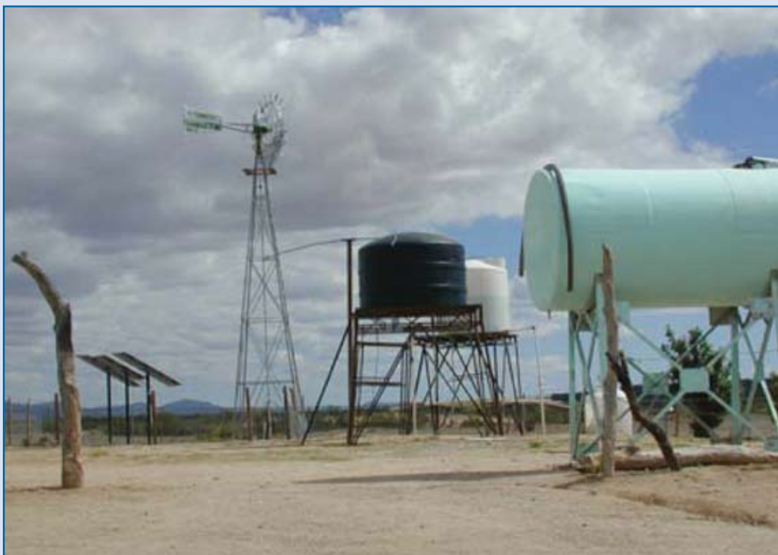
El nuevo tanque para el almacenamiento de agua de Quitovac ha incrementado la cantidad de agua almacenada que ahora tiene una duración de tres días; el nuevo sistema de almacenamiento de agua utiliza energía solar y eólica
