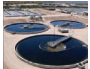
Planta de tratamiento de agua residual en Nogales.
