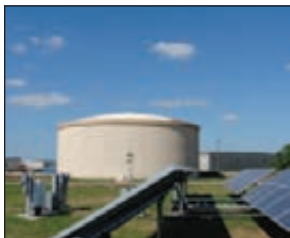
Matriz Solar en la Planta de Tratamiento de Agua de San Benito.
