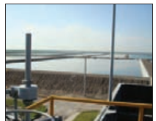
Planta de Tratamiento de Aguas Residuales en el Oeste de Matamoros: Sistema de lagunas y la primera planta de tratamiento de aguas residuales en Matamoros.
